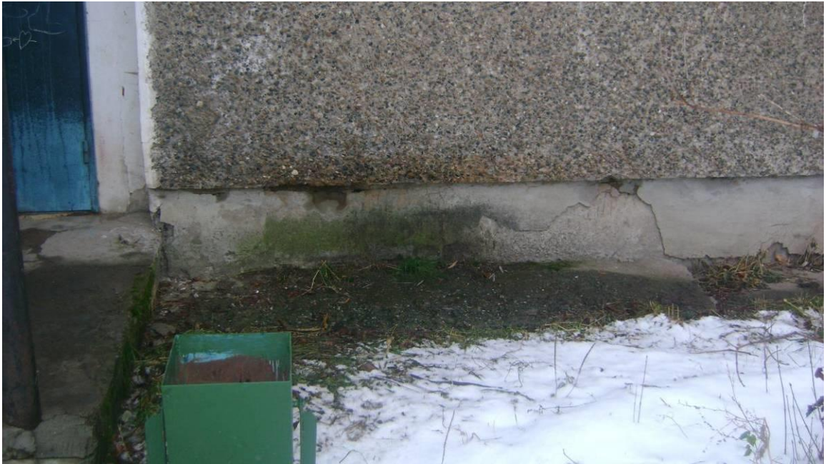
Фото 3. Следы увлажнения цоколя. Поражение цоколя и отмоксти биокоррозией.
