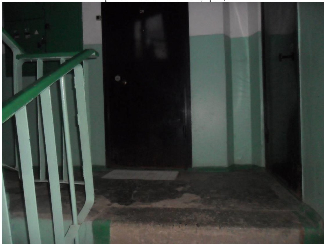
Фото 10. Подъезд. Местами сколы, выбоины в бетонном основании лестничной площадки.
