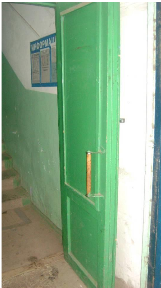
Фото 9. Подъезд. Отслаивания окрасочного слоя дверного полотна. Стертость дверных полотен. Рассыхание и коробление дверного проема. Неполный притвор по периметру коробки. Стирание поверхности бетонного пола, трещины
