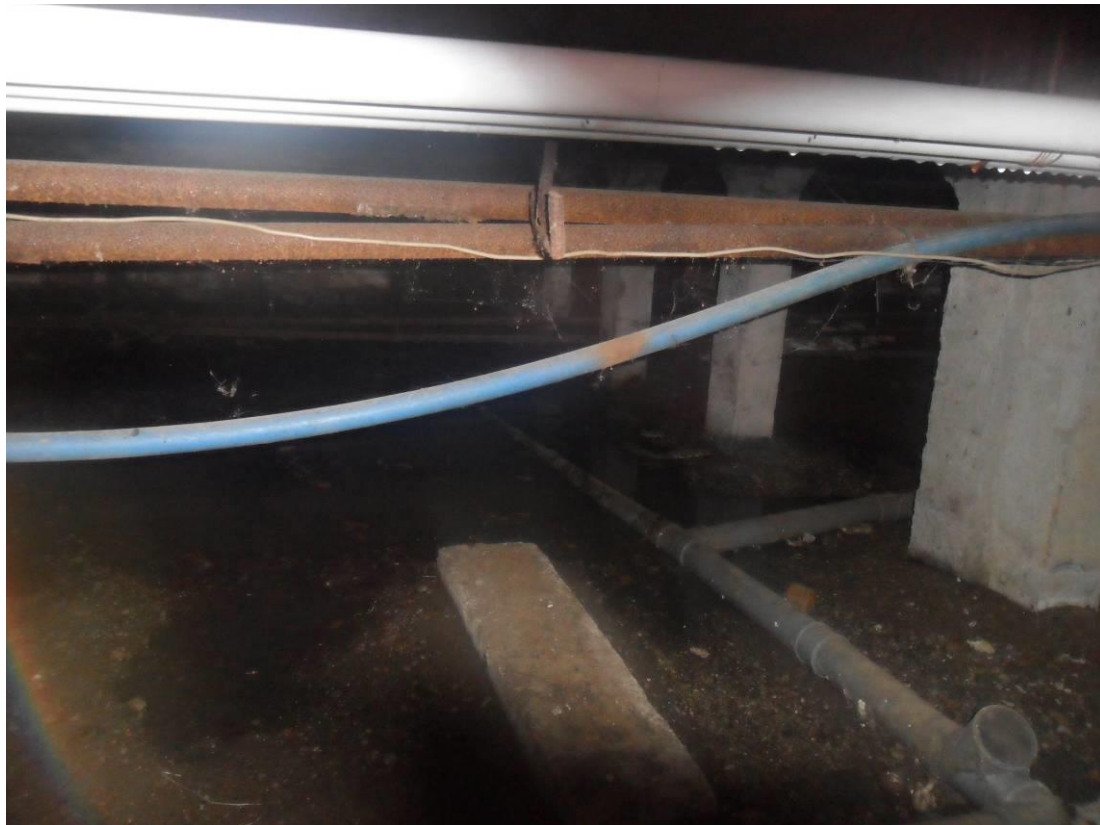
Фото 17. Техническое подполье. Следы замачивания пола технического подполья. Скопление строительного и бытового мусора. Частичное затопление технического подполья. Следы ремонта сетей водоснабжения и водоотведения.
