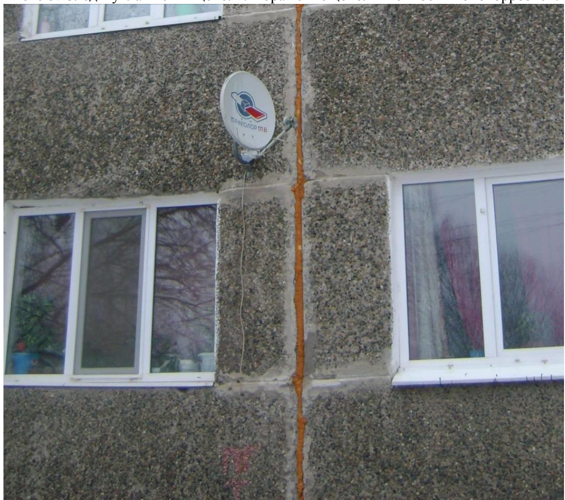
Фото 4. Фрагмент фасада. Заделка стыков между панелями. Трещины в швах между панелями.
