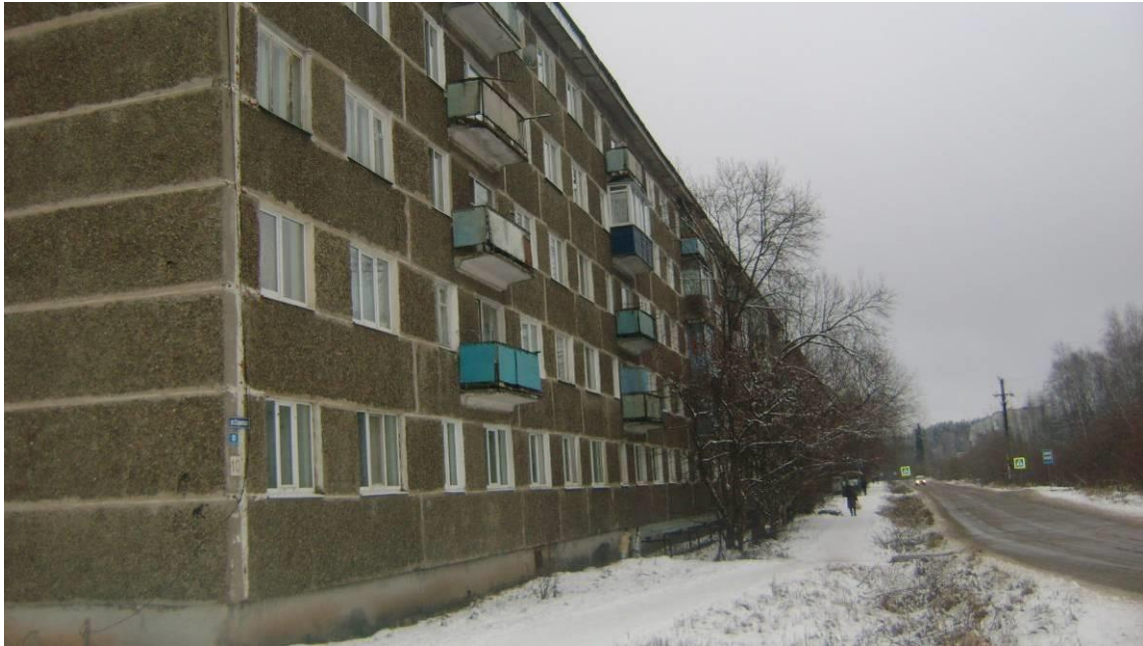
Фото 1. Фасад здания по ул. Строителей, д.10 в п.Оверята, Краснокамского района, Пермского края. Следы увлажнения цоколя. Поражение цоколя и отмостки биокоррозией.
