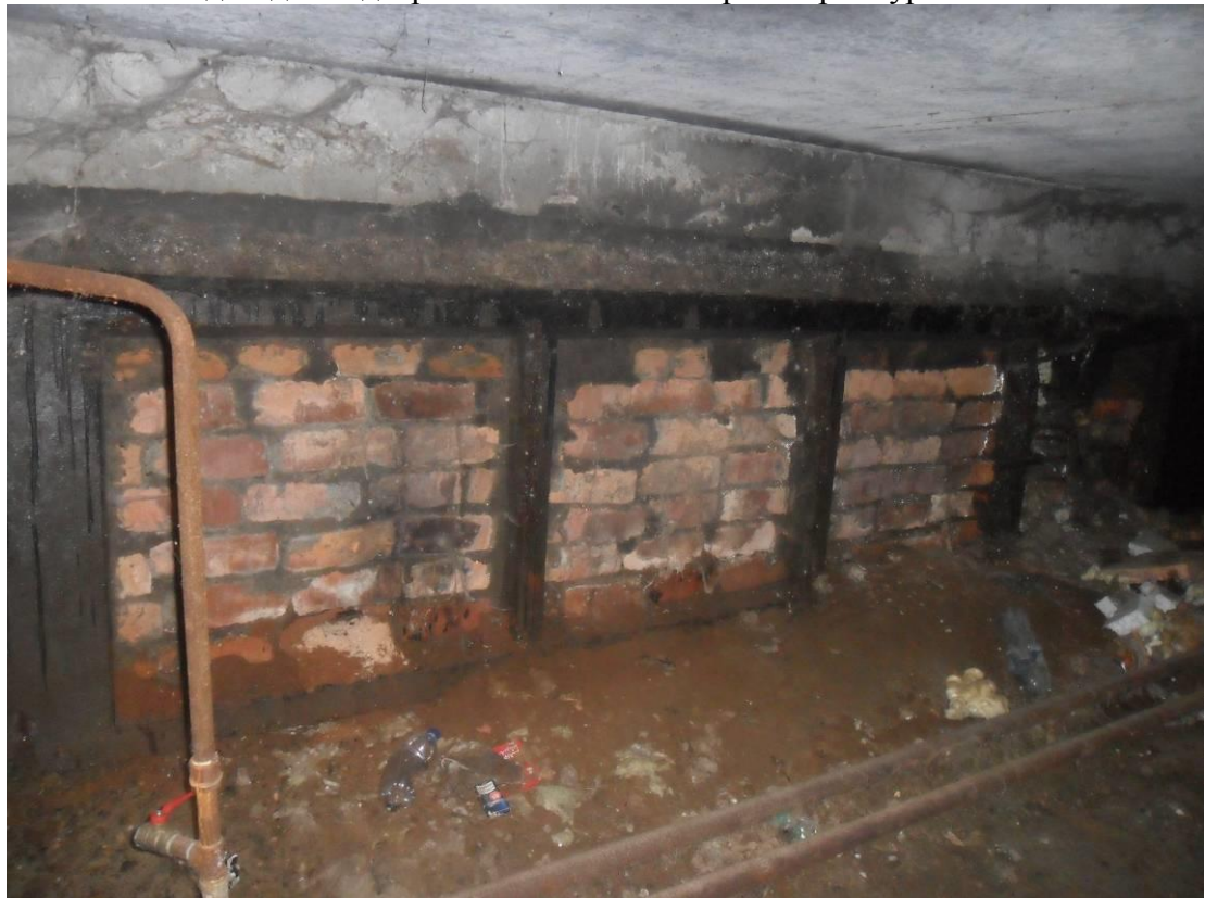
Фото 16. Техническое подполье. Следы замачивания стен, пола и подвального перекрытия технического подполья. Скопление строительного и бытового мусора.
