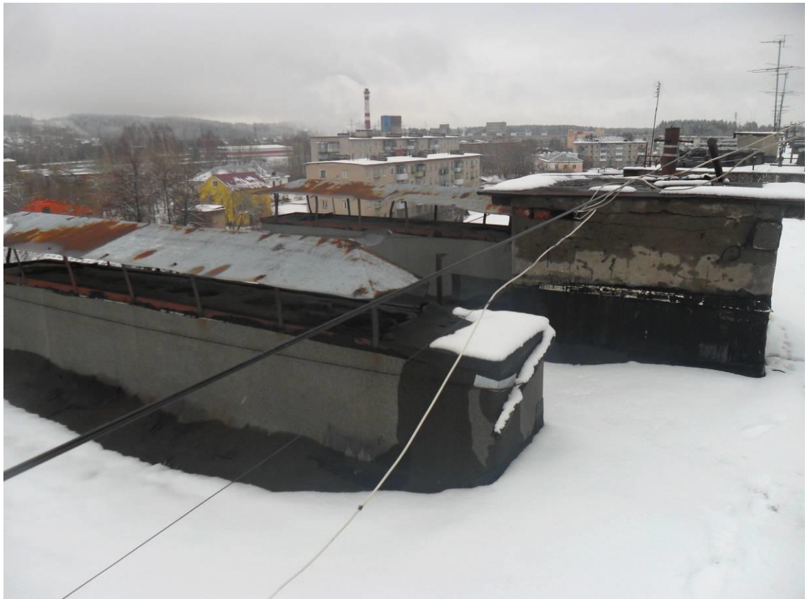
Фото 5. Общий вид крыши. Отсутствие организованного водостока. Следы увлажнения вентиляционных шахт.
