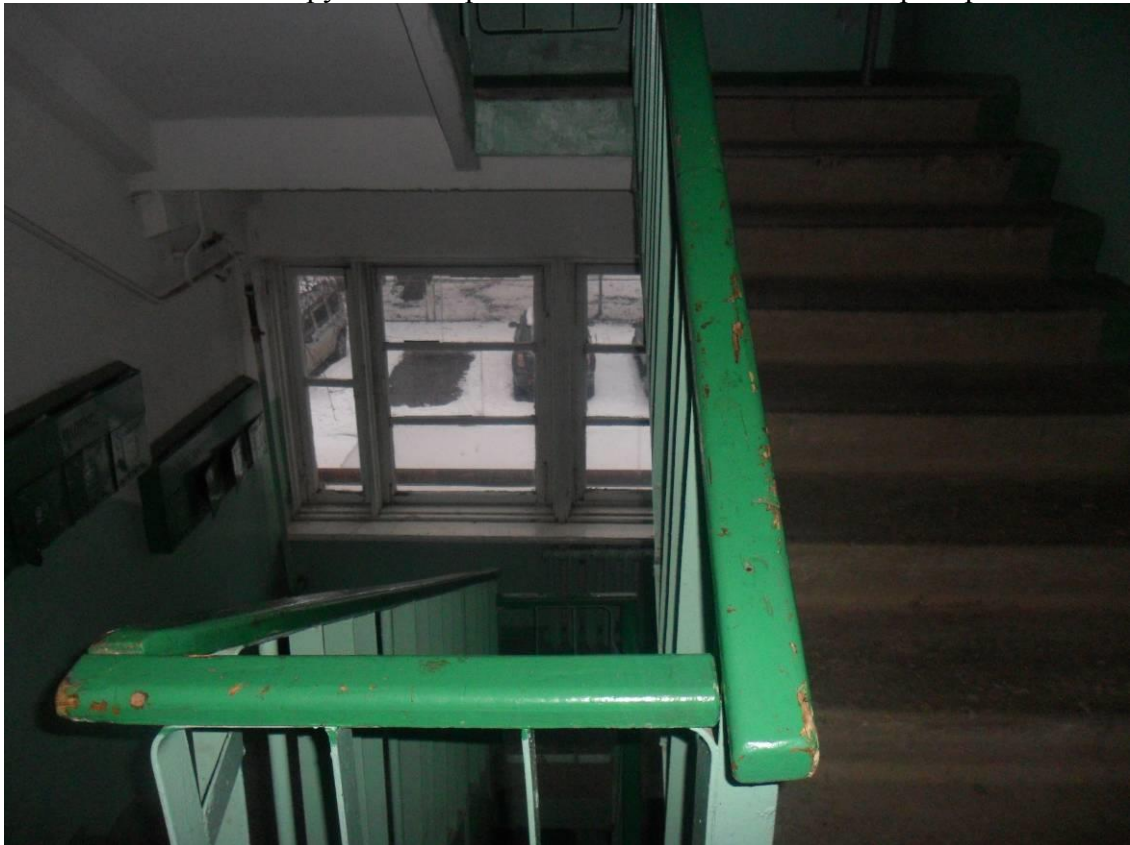
Фото 14 Подъезд. Стертость и сколы в перилах. Нарушение окрасочного слоя.
