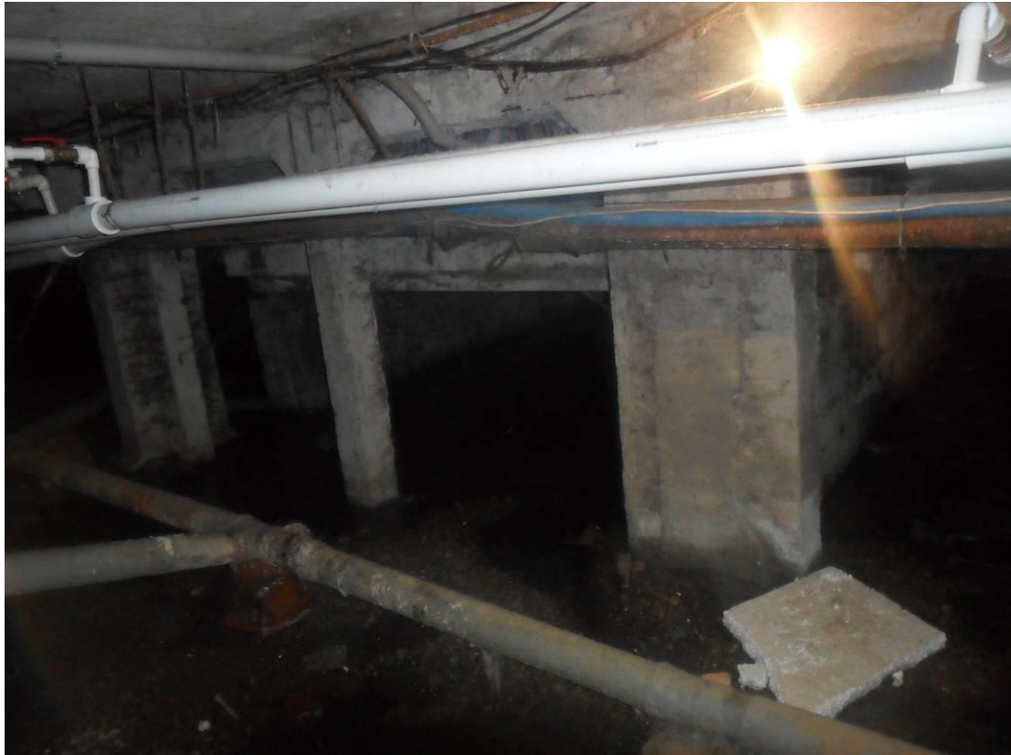
Фото 19. Техническое подполье. Следы замачивания пола технического подполья. Скопление строительного и бытового мусора. Частичное затопление технического подполья. Следы ремонта сетей водоснабжения и водоотведения. Общее моральное устаревание сетей электроснабжения.
