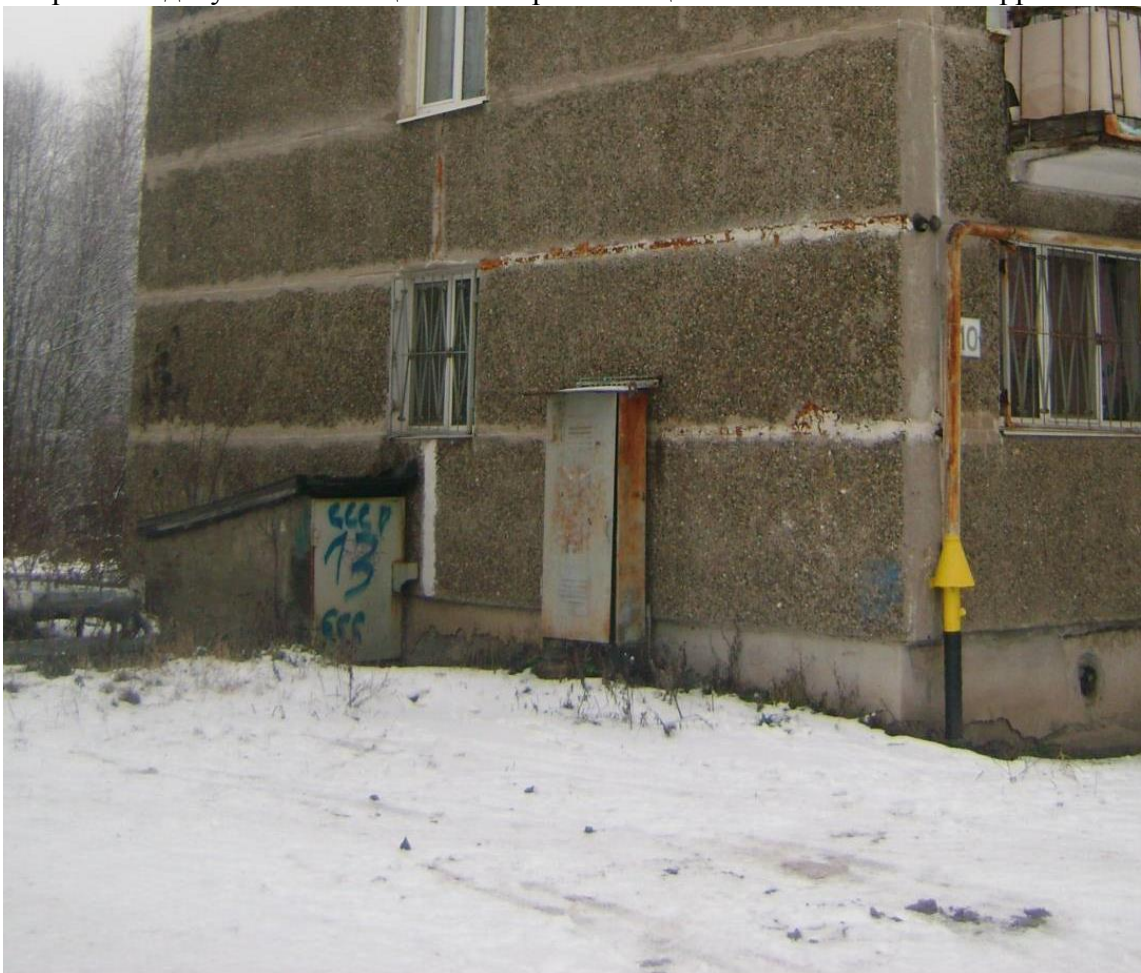
Фото 2. Фасад здания со стороны двора. Следы увлажнения цоколя. Поражение цоколя биокоррозией. Следы увлажнения поверхности стен. Трещины в швах между панелями.
