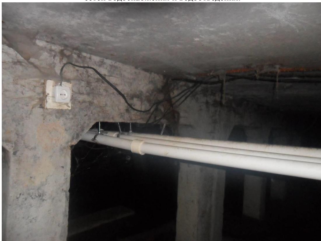
Фото 18. Техническое подполье. Следы замачивания стен и подвального перекрытия технического подполья. Следы ремонта сетей водоснабжения. Скрутка электрических проводов.
