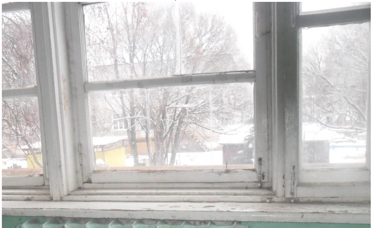
Фото 6. Подъезд. Оконные деревянные переплеты и коробки рассохлись, покособились местами расшатаны. Отслаивание окрасочного слоя оконных блоков.
