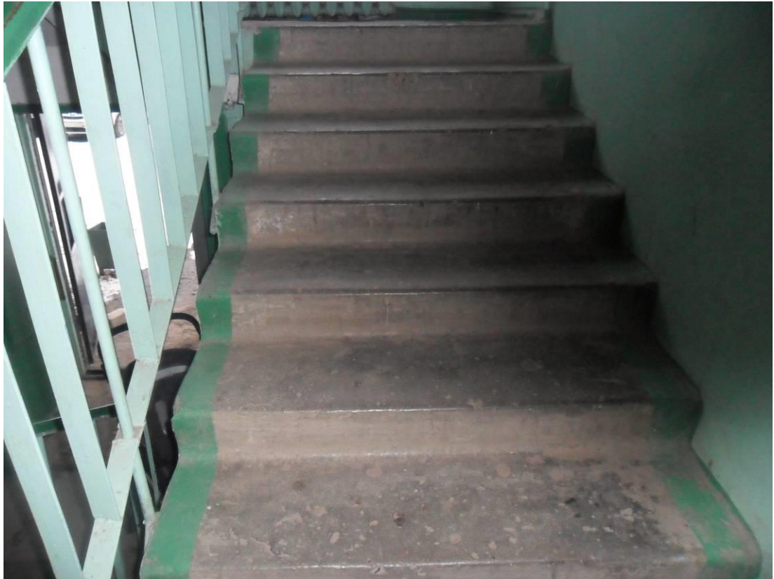
Фото 11. Подъезд. Стертость ступеней лестниц. Сколы бетона ступеней лестниц. Отслаивание окрасочного слоя ступеней лестниц.
