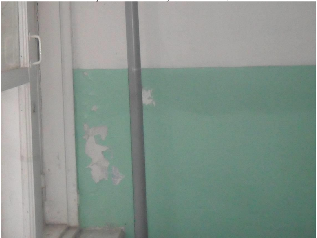
Фото 12. Подъезд. Локальные участки разрушения штукатурного и отслаивания окрасочного слоя внутренних стен.
