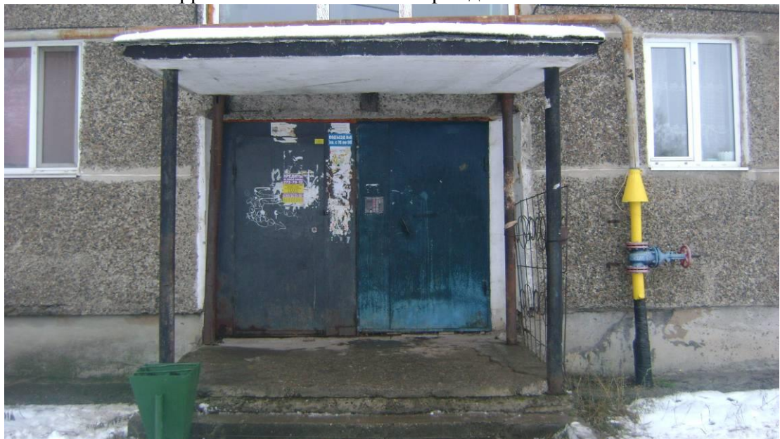
Фото 8. Подъезд. Следы увлажнения цоколя. Поражение цоколя, отмостки и бетонного крыльца биокоррозией. Трещины, сколы в бетонном крыльце. Следы увлажнения бетонного крыльца. Следы коррозии деталей дверных полотен. Отслаивания окрасочного слоя дверного полотна.
