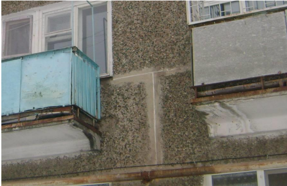
Фото 7. Фасад здания. Разрушение защитного слоя бетона балконной плиты. Поражение коррозией металлических ограждений балконов.
