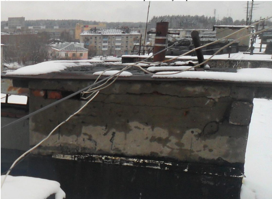
Фото 20. Крыша. Следы ремонта кровельного покрытия. Следы увлажнения вентиляционных шахт. Разрушение кладки вентиляционной трубы. Разрушение штукатурного слоя вентиляционных труб.
