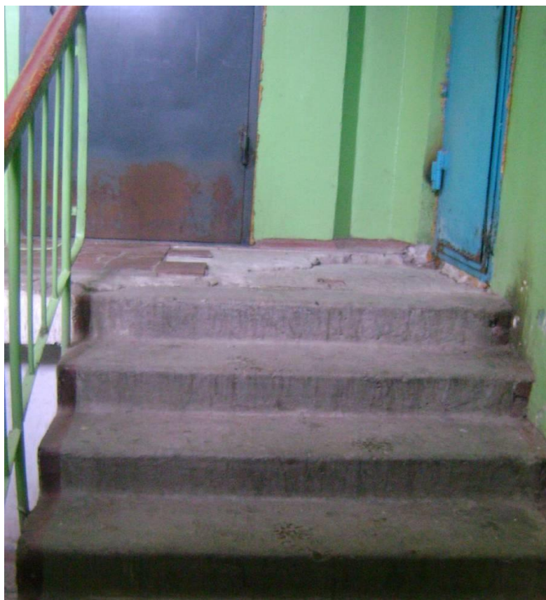
Фото 7. Подъезд. Массовое отставание плитки и основания на лестничных площадках.
