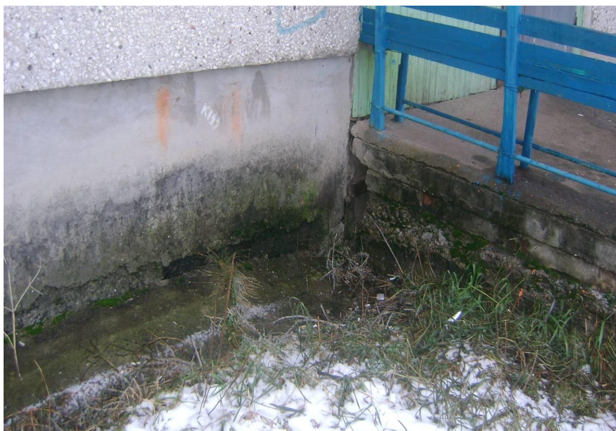
Фото 22. Фасад здания со стороны двора. Увлажнение, сколы, биокоррозия цоколя, крыльца.
