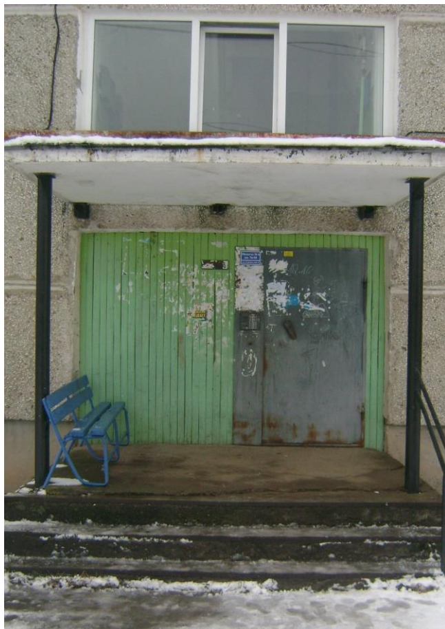
Фото 5. Подъезд. Трещины, сколы в бетонном крыльце. Коррозия дверных полотен, повреждение окрасочного слоя.
