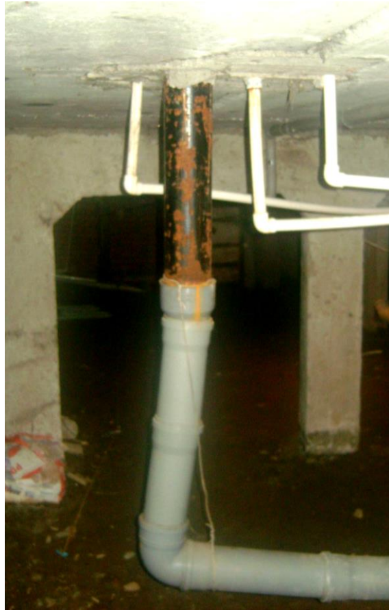
Фото 15. Техническое подполье. Канализационный стояк. Следы ремонта трубопроводов. Повреждения чугунных трубопроводов.
