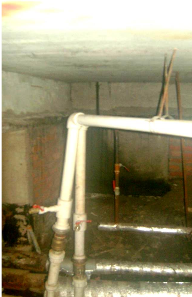
Фото 18. Техническое подполье. Следы ремонта трубопроводов. Коррозия стальных трубопроводов.
