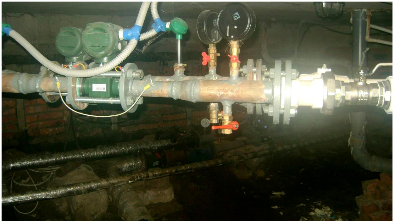
Фото 16. Техническое подполье. Замена приборов учета системы водоснабжения. Следы ремонта трубопроводов. Коррозия стальных трубопроводов, ослабление сальниковых набивок и прокладок.
