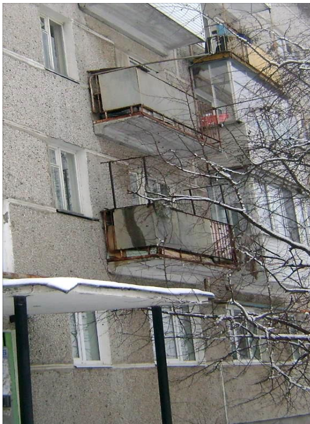
Фото 21. Фасад здания со стороны двора. Повреждения и коррозия металлических обделок и ограждений балконов.
