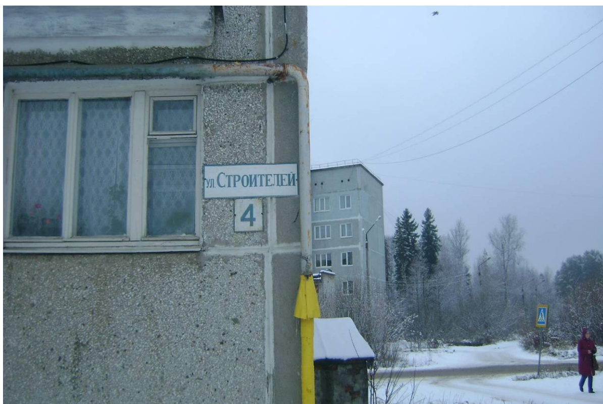
Фото 20. Фасад здания со стороны двора. Труба газоснабжения. Нарушение окрасочного слоя.
