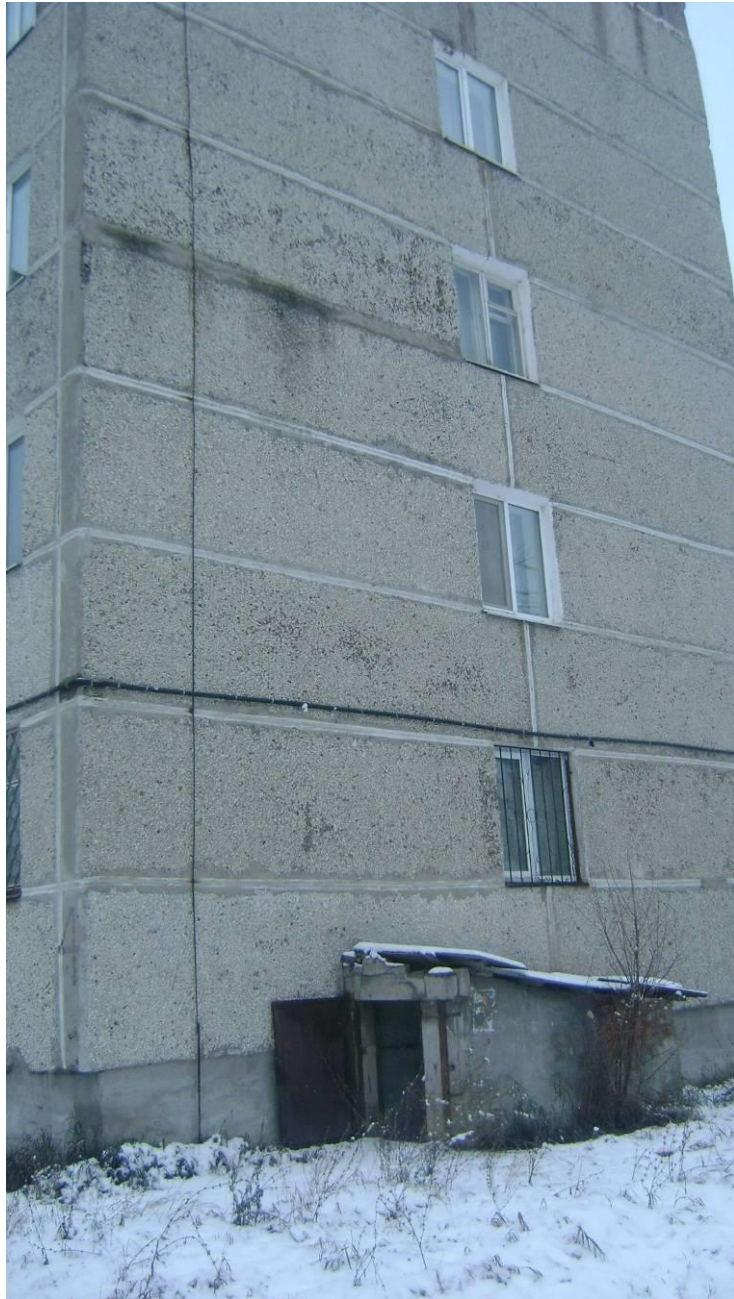
Фото 25. Торцевая сторона здания. Следы протечек с крыши здания.
