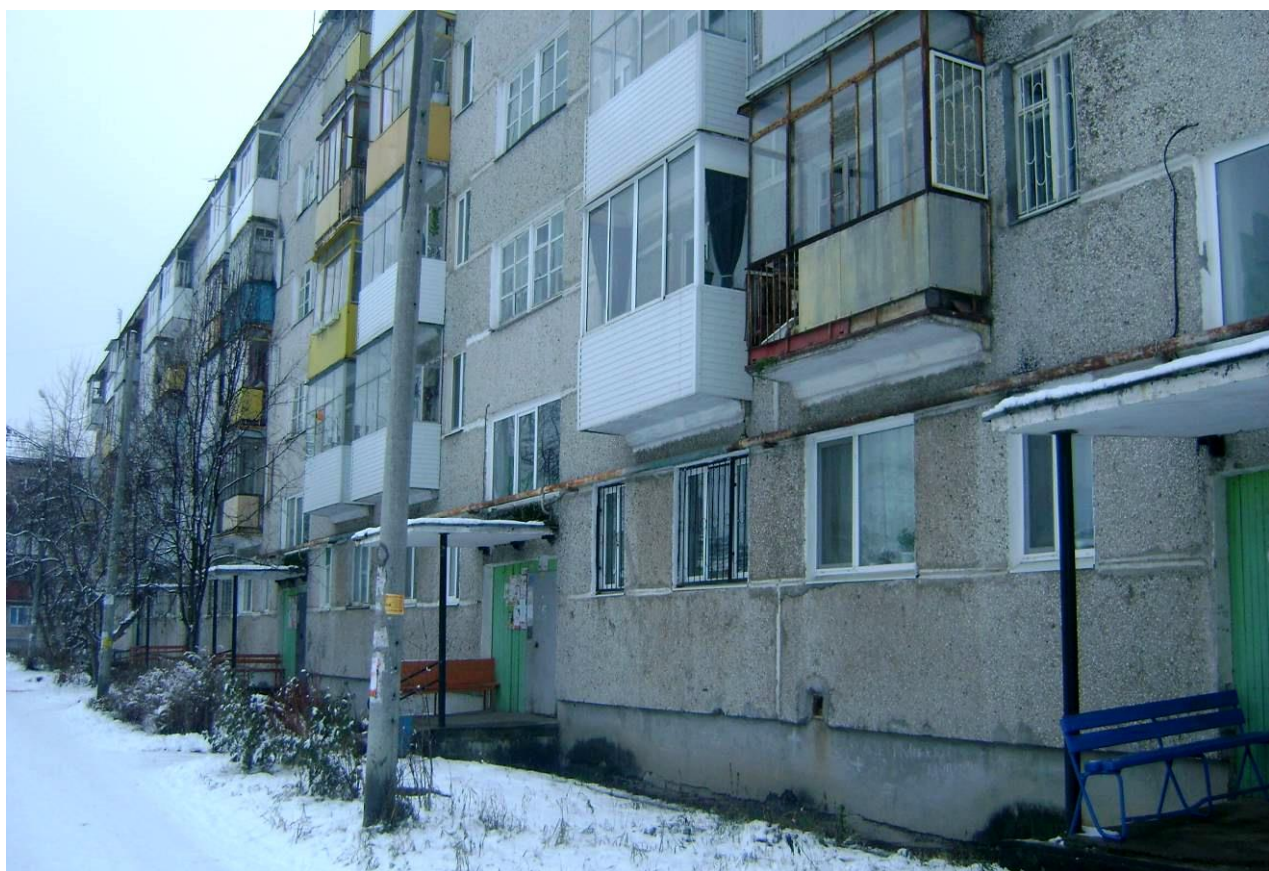
Фото 2. Фасад здания со стороны двора. Следы увлажнения цоколя.
