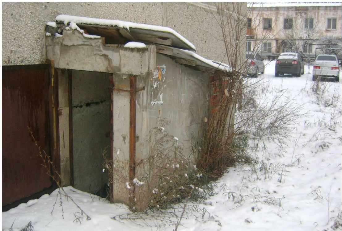
Фото 14. Вход в техническое подполье. Ослабление и разрушение кирпичной кладки. Отклонение о вертикали.
