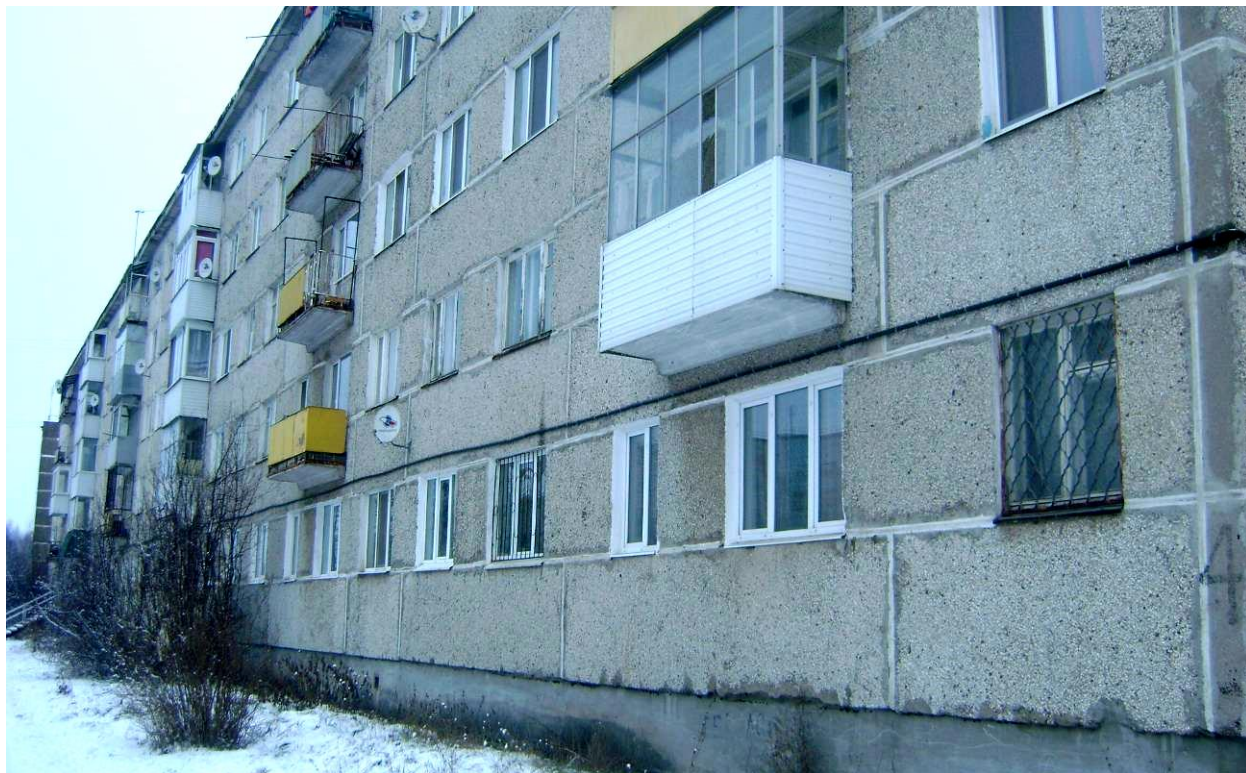
Фото 1. Фасад здания по ул. Строителей, д.4 в п. Оверята, Краснокамского района, Пермского края. Следы увлажнения цоколя.
