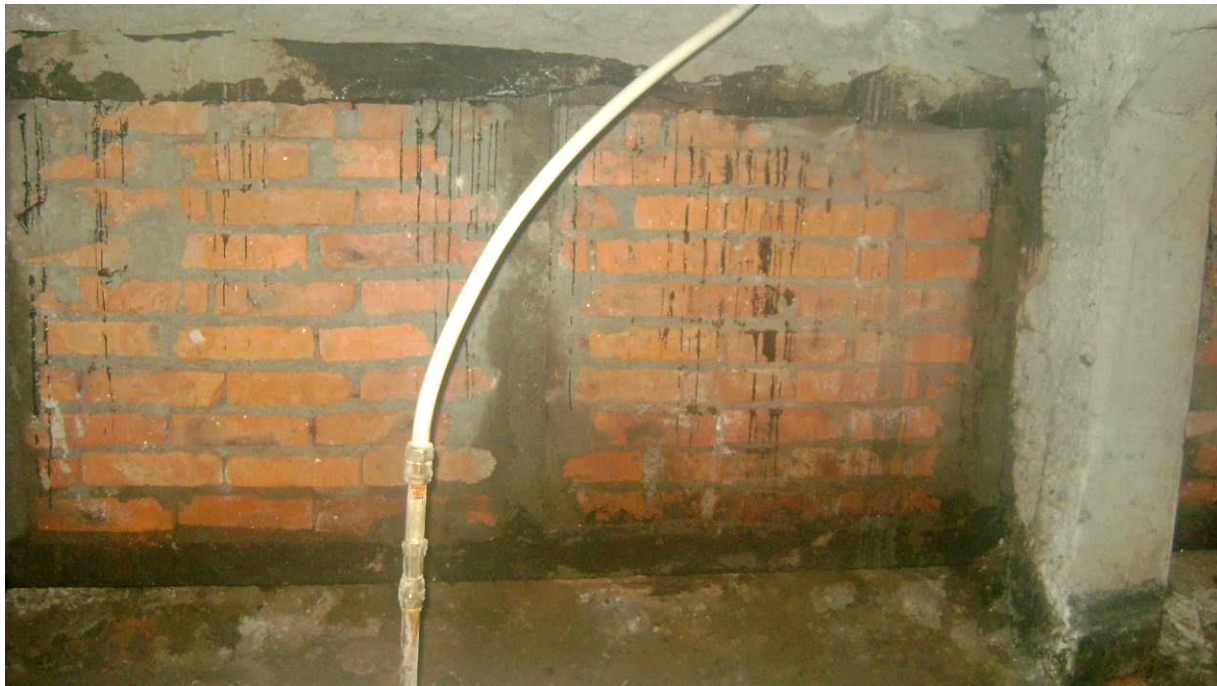
Фото 19. Техническое подполье. Увлажнение цоколя.
