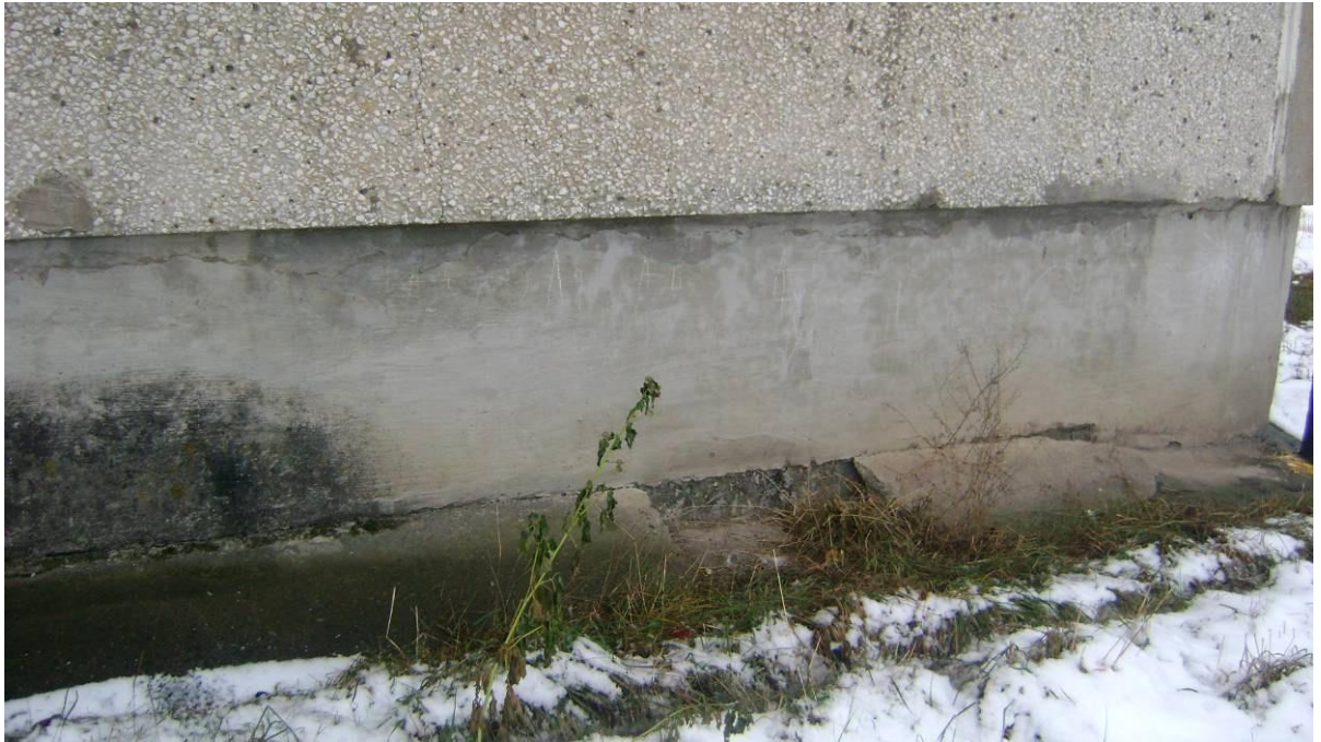
Фото 3. Фасад здания со стороны двора. Следы увлажнения, биокоррозия цоколя. Трещины, просадка, отсутствие местами отмостки.
