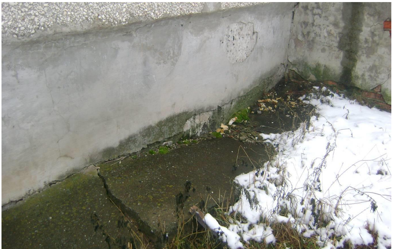
Фото 4. Фасад здания со стороны двора. Нарушение штукатурного слоя цоколя, следы увлажнения, биокоррозия. Расколы, просадка, увлажнение отмостки.
