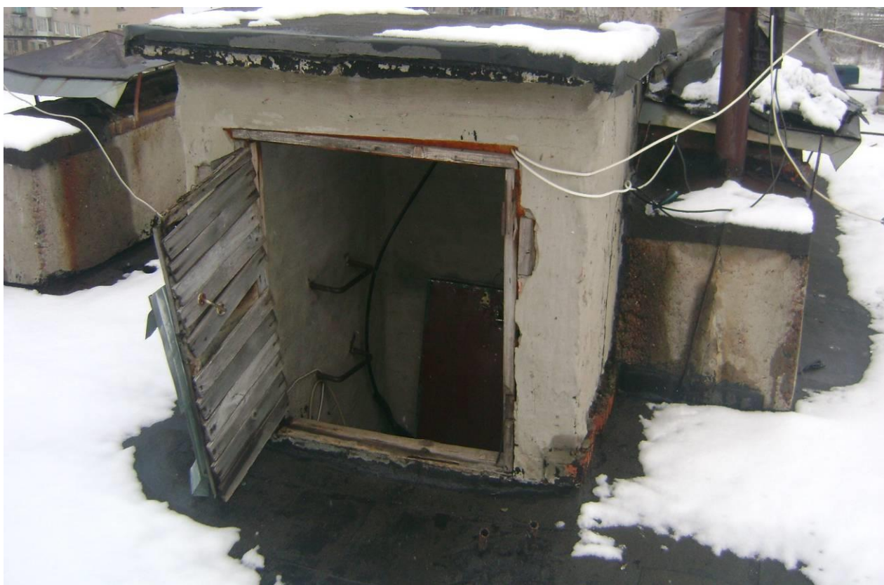
Фото 12. Выход на крышу. Полное расшатывание, повреждение дверных полотен.
