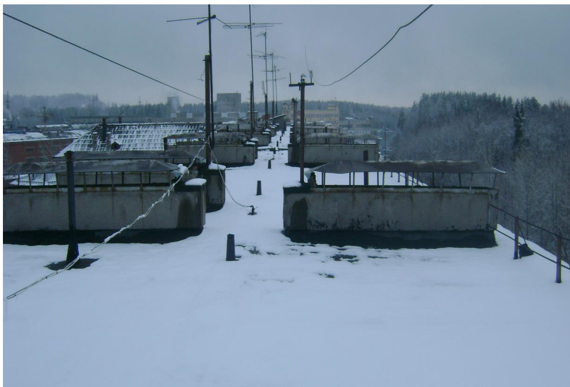
Фото 11. Общий вид крыши. Увлажнение поверхности стен вентиляционных шахт.
