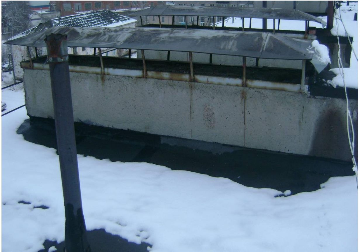
Фото 13. Вентиляционные шахты. Следы увлажнения. Ржавление металлических ограждающих элементов, ржавые потеки.
