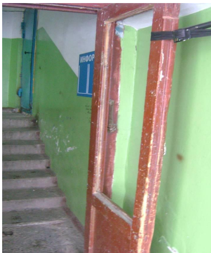
Фото 6. Подъезд. Отсутствие части заполнения дверного полотна, повреждения, расшатывание.
