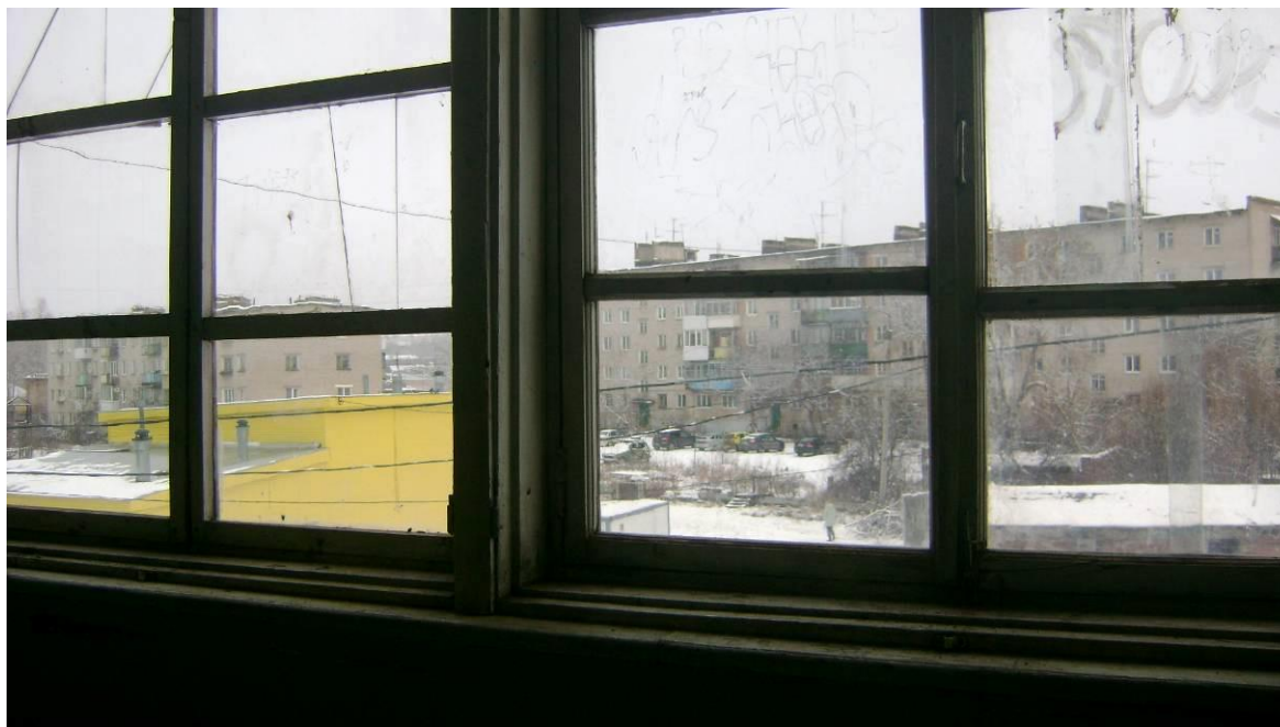
Фото 8. Подъезд. Трещины, щели в местах сопряжения коробок со стенами, переплеты разошлись, расшатаны, древесина расслаивается, отсутствие части приборов.
