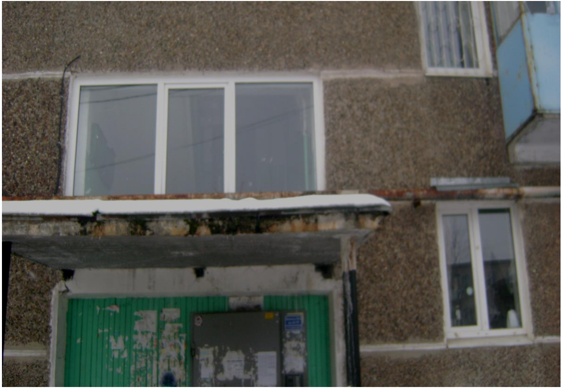
Фото 17. Козырек крыльца. Увлажнение, биокоррозия.
