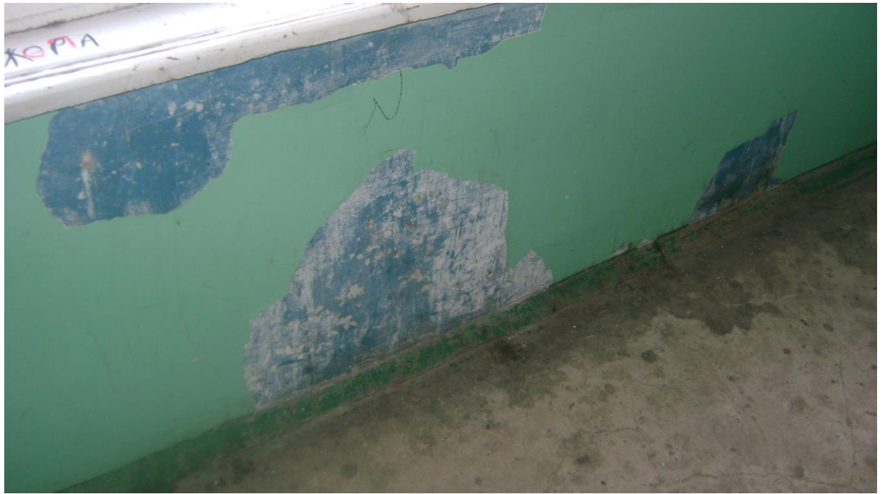
Фото 11. Подъезд. Повреждения штукатурного и окрасочного слоя стен.
