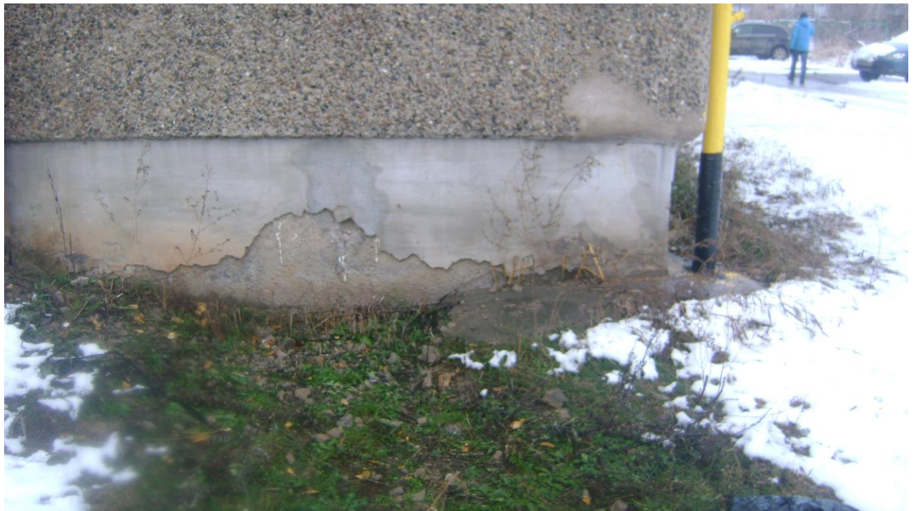
Фото 4. Фасад здания со стороны двора. Нарушение штукатурного слоя цоколя, следы увлажнения, биокоррозия. Расколы, просадка, местами отсутствие отмостки.
