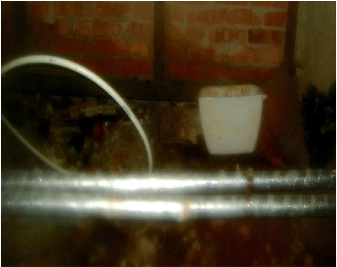
Фото 25. Техническое подполье. Следы увлажнения цоколя.
