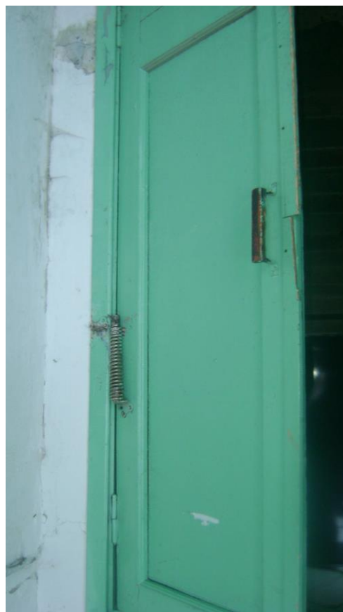
Фото 6. Подъезд. Повреждения полотен, приборов, неплотный притвор.
