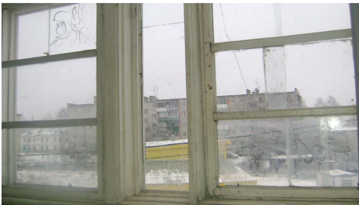
Фото 10. Подъезд. Трещины, щели в местах сопряжения коробок со стенами, переплеты разошлись, расшатаны, древесина расслаивается, поражение гнилью, отсутствие части приборов.
