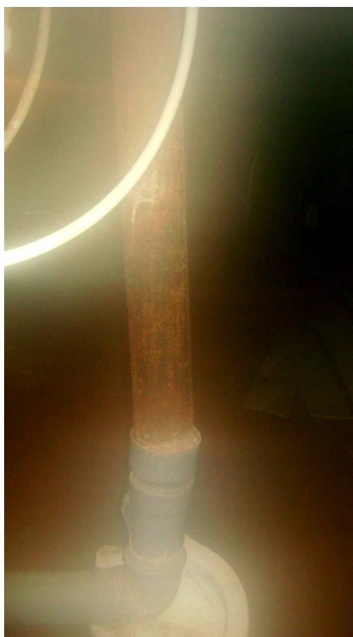
Фото 22. Техническое подполье. Следы ремонта трубопровода водоотведения. Повреждение чугунных труб.
