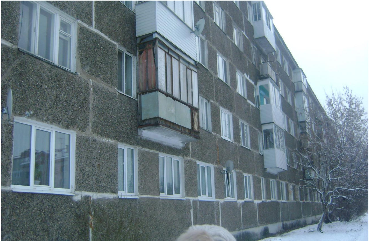
Фото 1. Фасад здания по ул. Строителей, д. 6 в п. Оверята, Краснокамского района, Пермского края. Следы увлажнения цоколя, стен.
