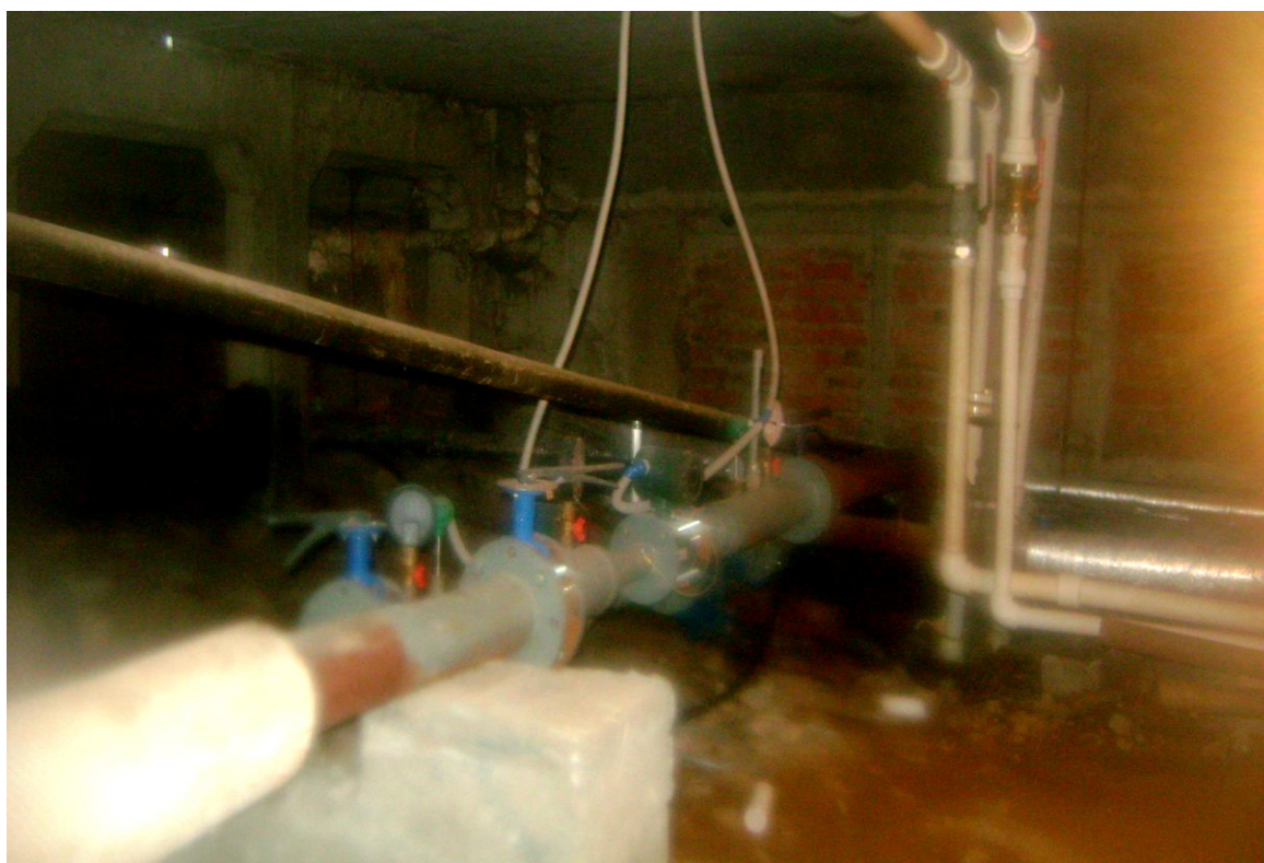
Фото 24. Техническое подполье. Замена приборов учета системы отопления. Коррозия стальных трубопроводов.
