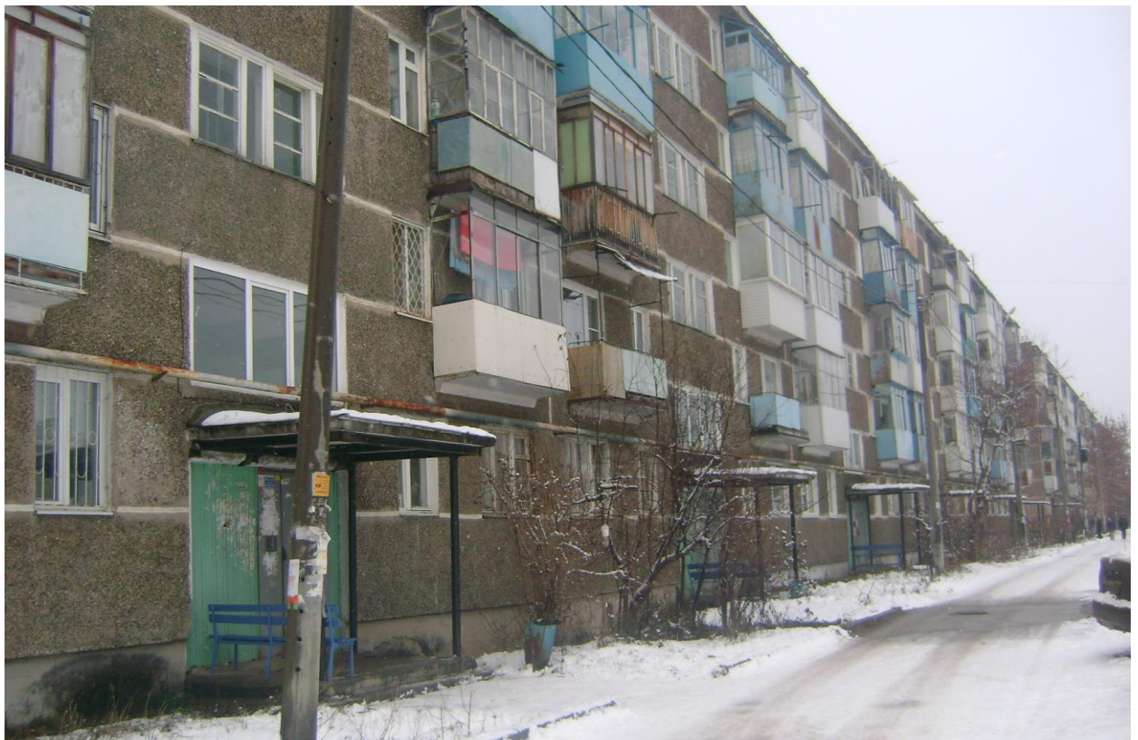
Фото 2. Фасад здания со стороны двора. Следы увлажнения цоколя.
