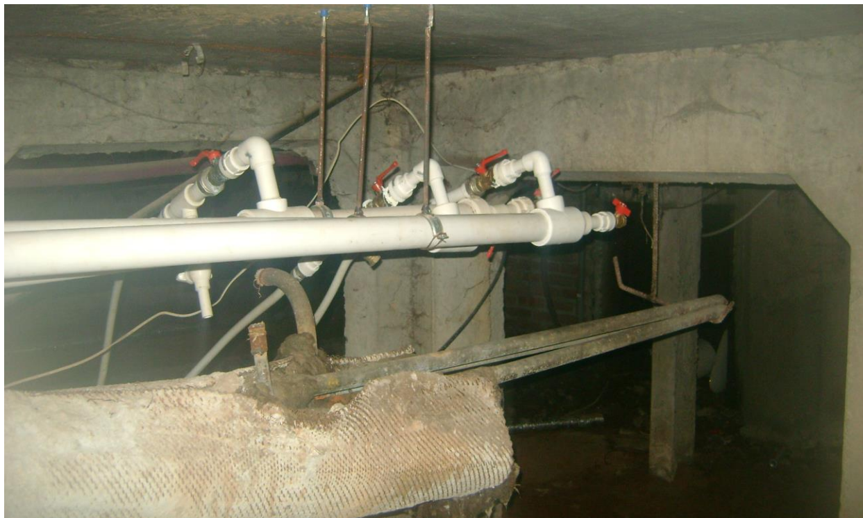
Фото 21. Техническое подполье. Следы ремонта сетей водоснабжения. Коррозия стальных трубопроводов.
