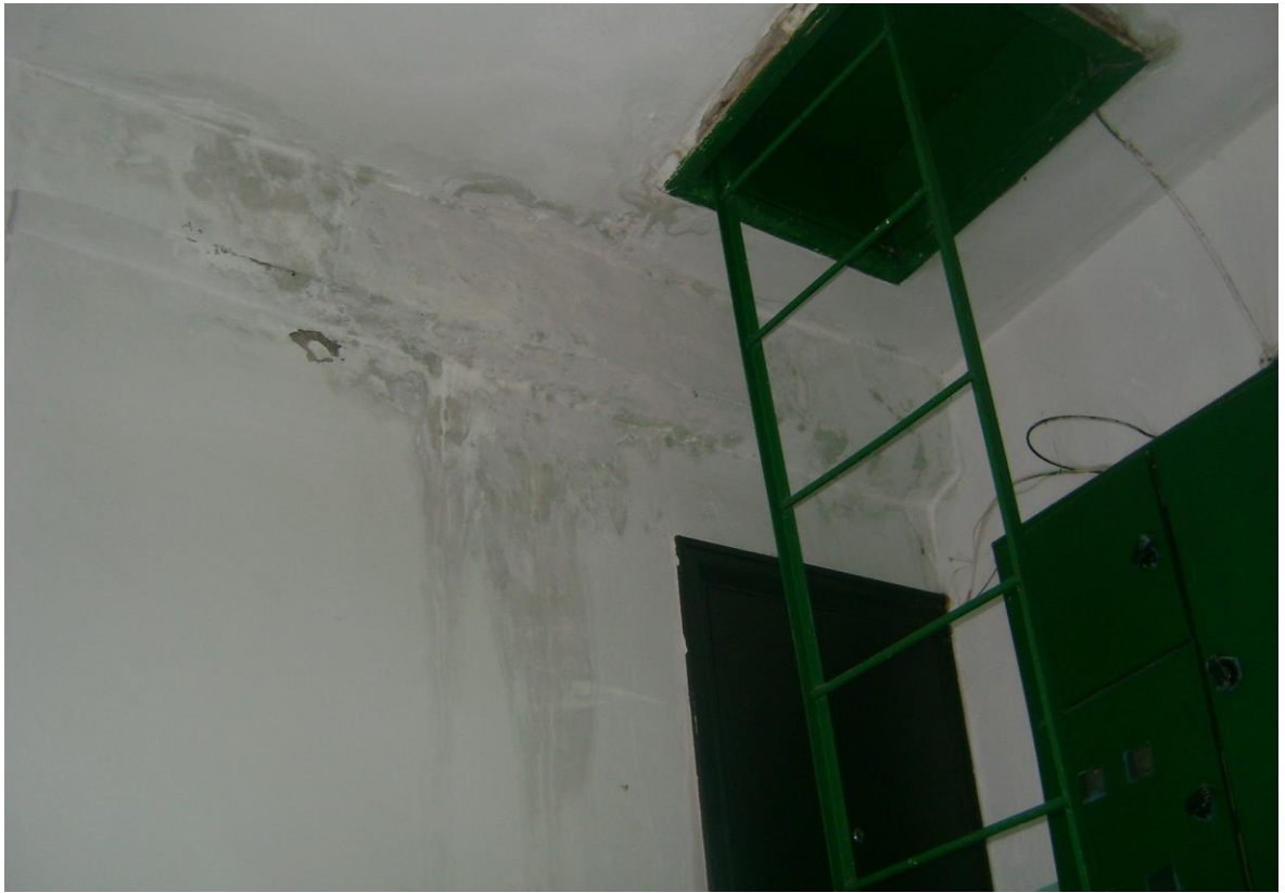
Фото 13. Подъезд. Лестница на крышу. Следы протечек на плитах и стенах в местах опирания.
