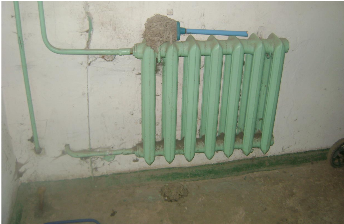
Фото 9. Подъезд. Нарушение окрасочного слоя отопительных приборов. Стирание поверхности бетонного пола, трещины.
