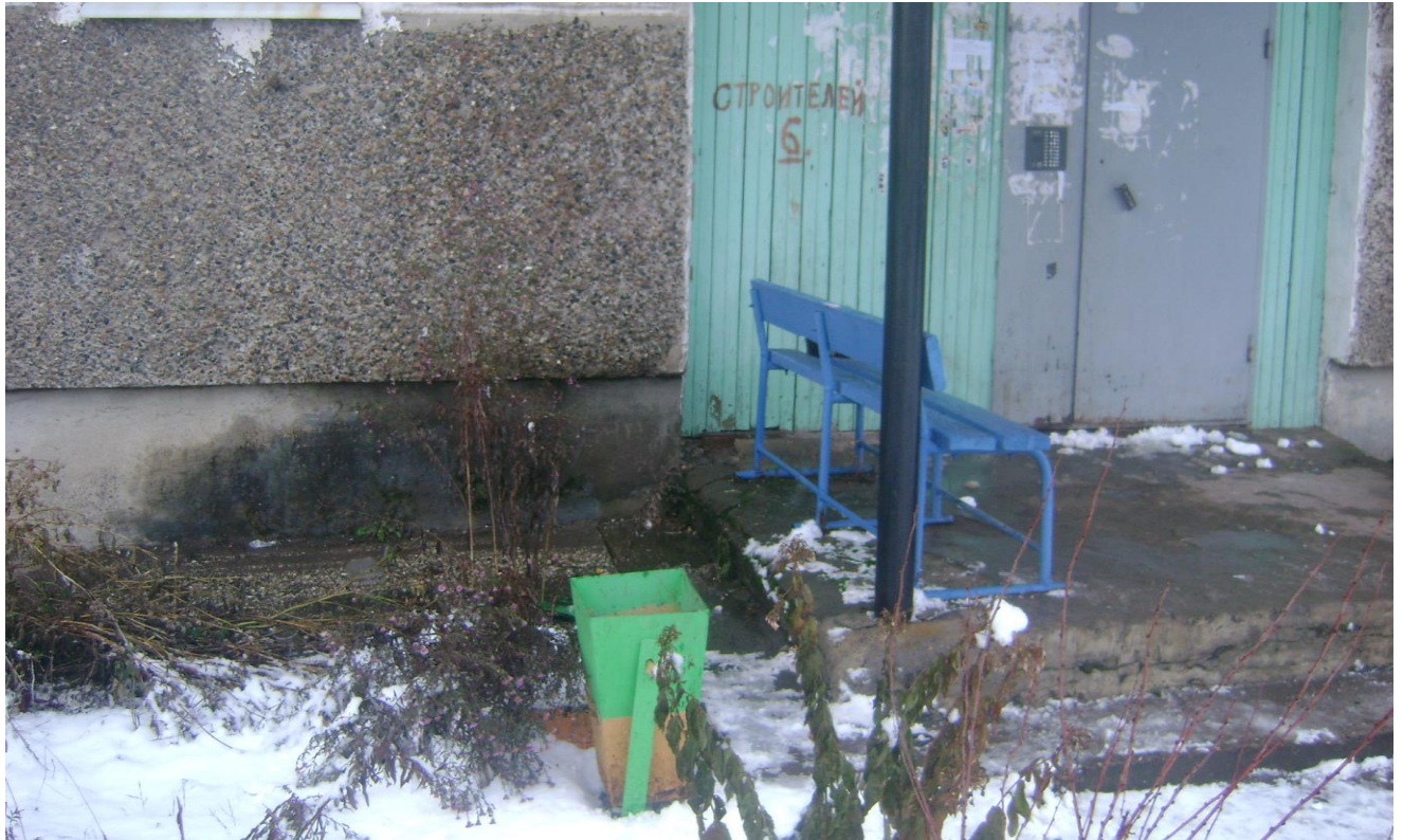
Фото 5. Подъезд. Трещины, сколы в бетонном крыльце. Следы увлажнения поверхности стен, цоколя. Биокоррозия цоколя, крыльца. Коррозия дверных полотен, повреждение окрасочного слоя.
