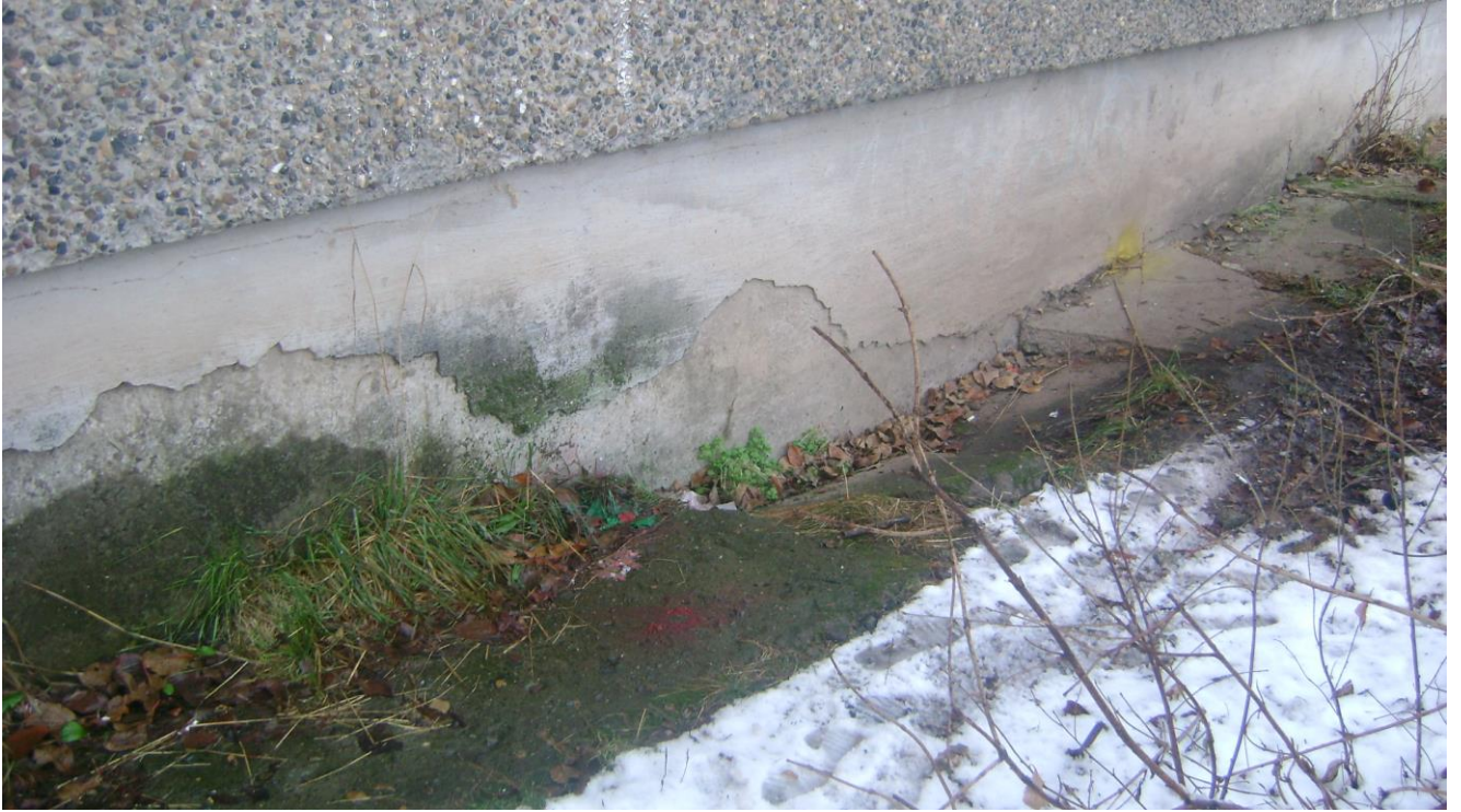
Фото 3. Фасад здания со стороны двора. Нарушение штукатурного слоя, следы увлажнения, биокоррозия цоколя. Расколы, просадка, увлажнение отмостки.
