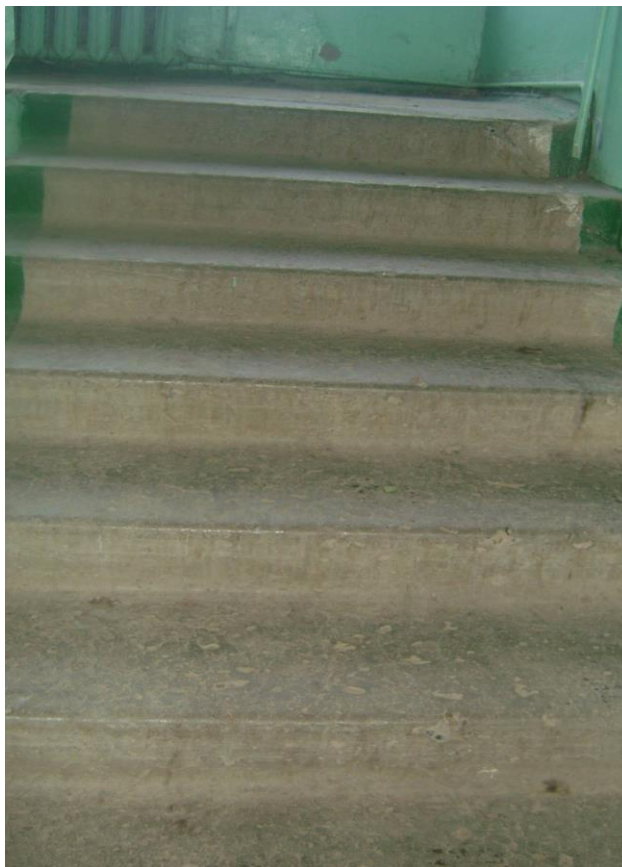
Фото 7. Подъезд. Лестничный марш. Единичные сколы, трещины на ступенях.
