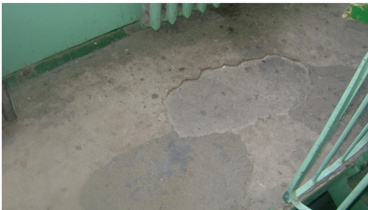
Фото 8. Подъезд. Местами сколы, выбоины в бетонном основании лестничной площадки.
