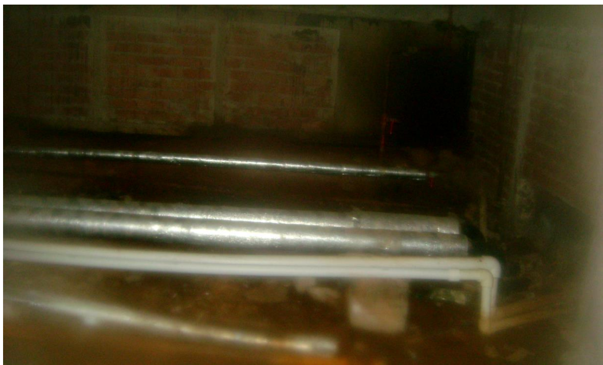
Фото 23. Техническое подполье. Следы ремонта отопительной системы, сетей водоснабжения.
