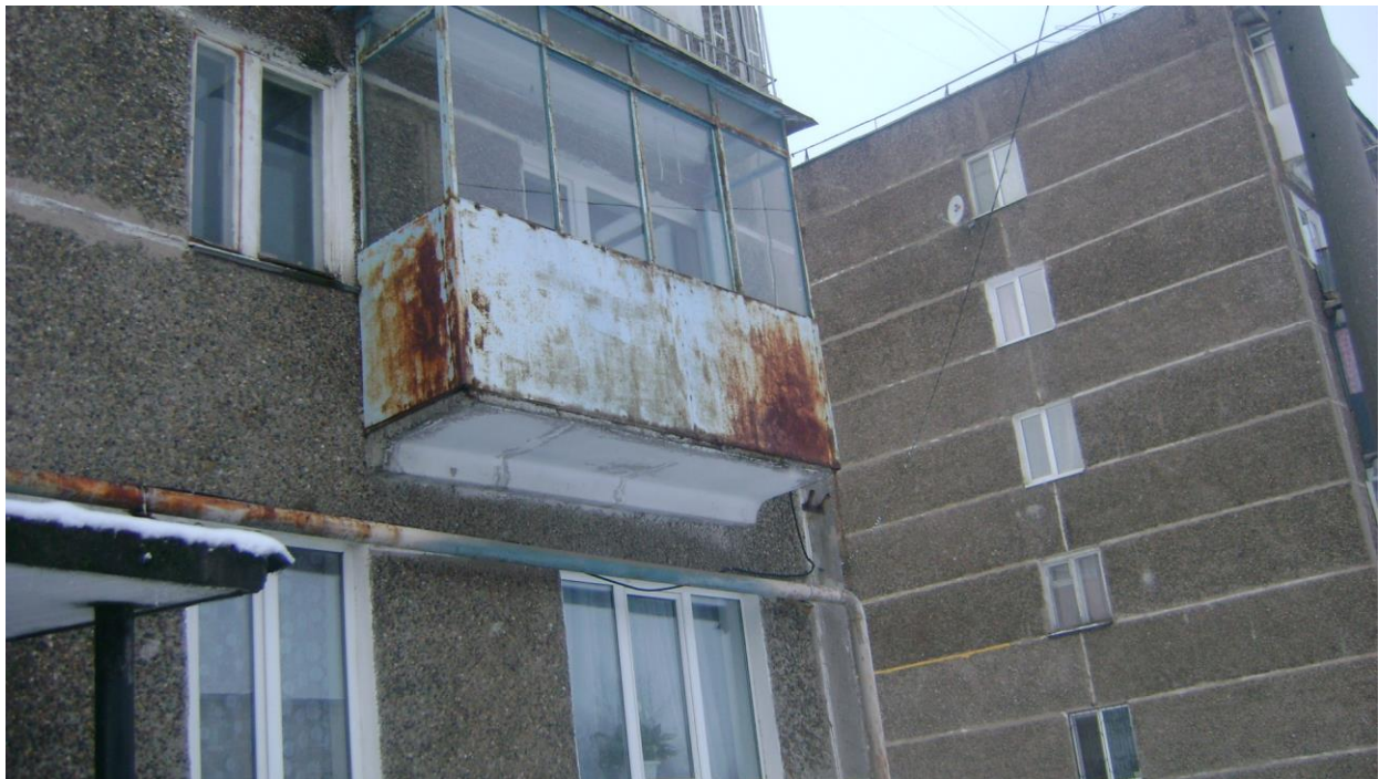
Фото 18. Фасад здания со стороны двора. Повреждения и коррозия металлических обделок и ограждений балконов.
