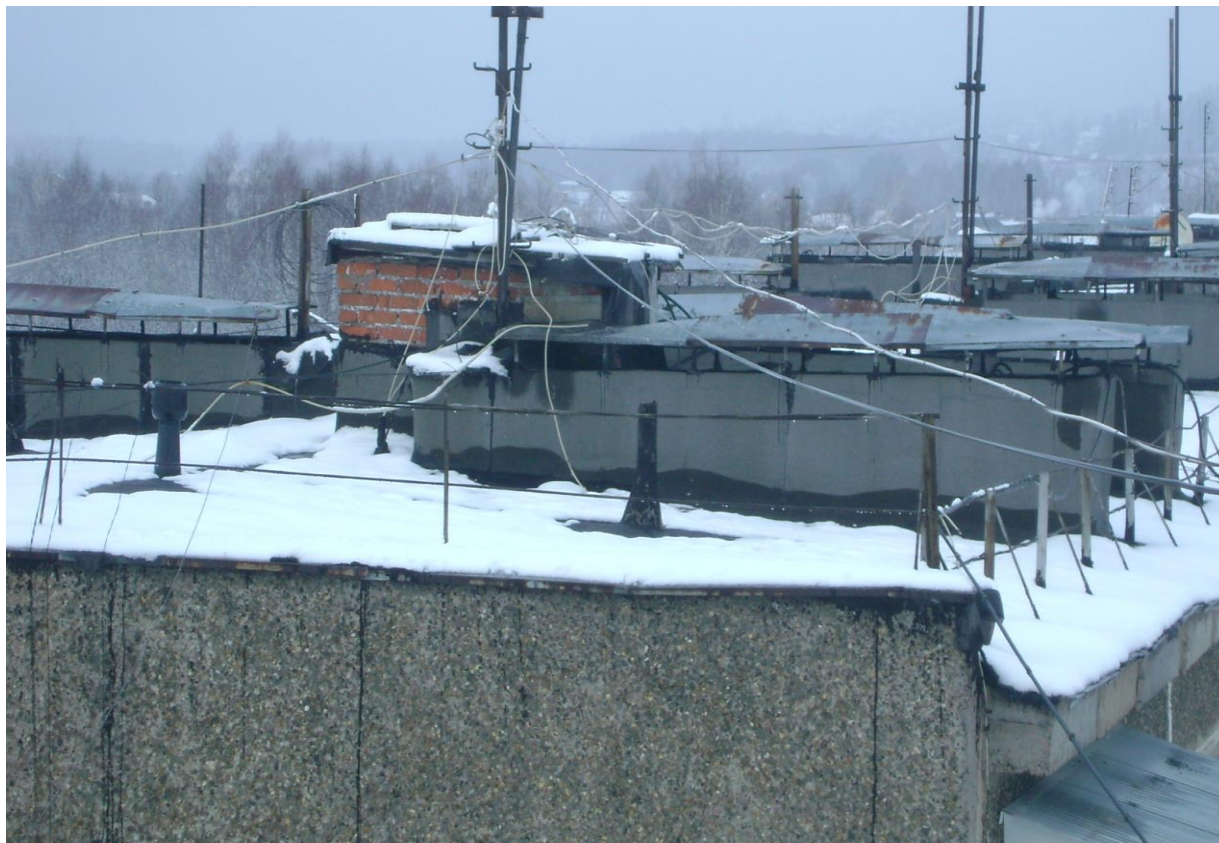
Фото 15. Крыша. Следы увлажнения поверхности вентиляционных шахт. Ржавление металлических ограждающих элементов.
