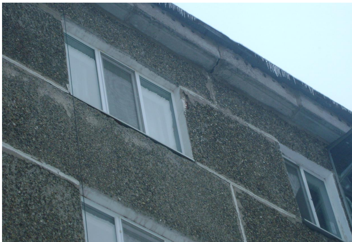
Фото 16. Плиты перекрытия. Увлажнение, образование наледи, трещины в швах между плитами.
