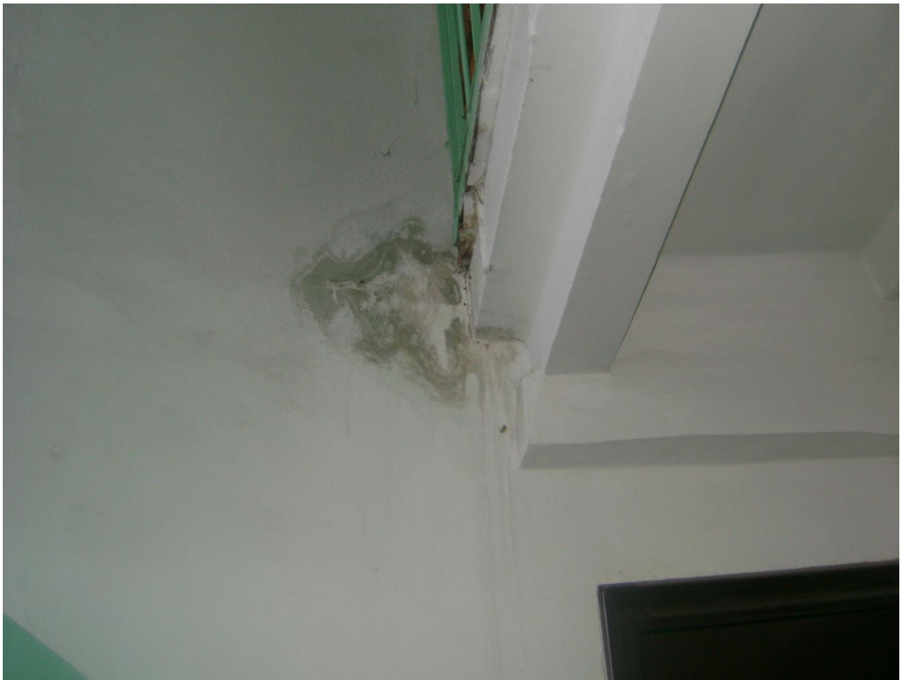
Фото 12. Подъезд. Следы протечек.
