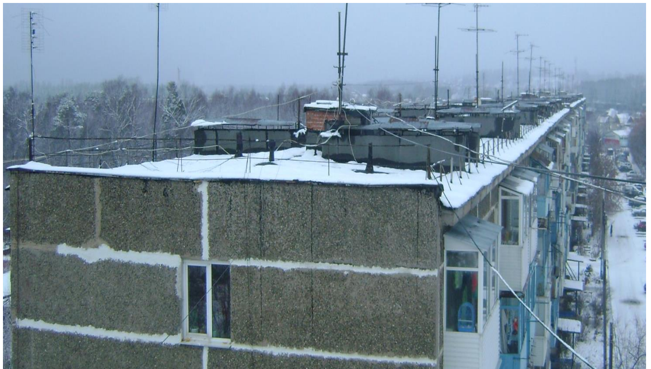
Фото 14. Общий вид крыши. В зимний период образование наледи по краям крыши.
