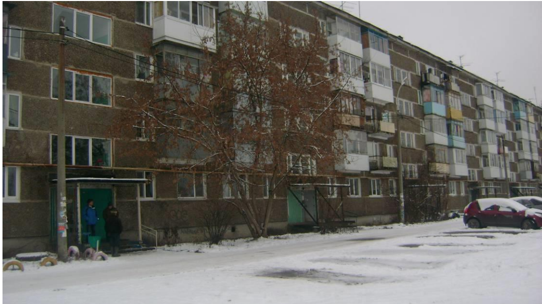
Фото 1. Фасад здания. Выветривания раствора из швов между стеновыми панелями.
