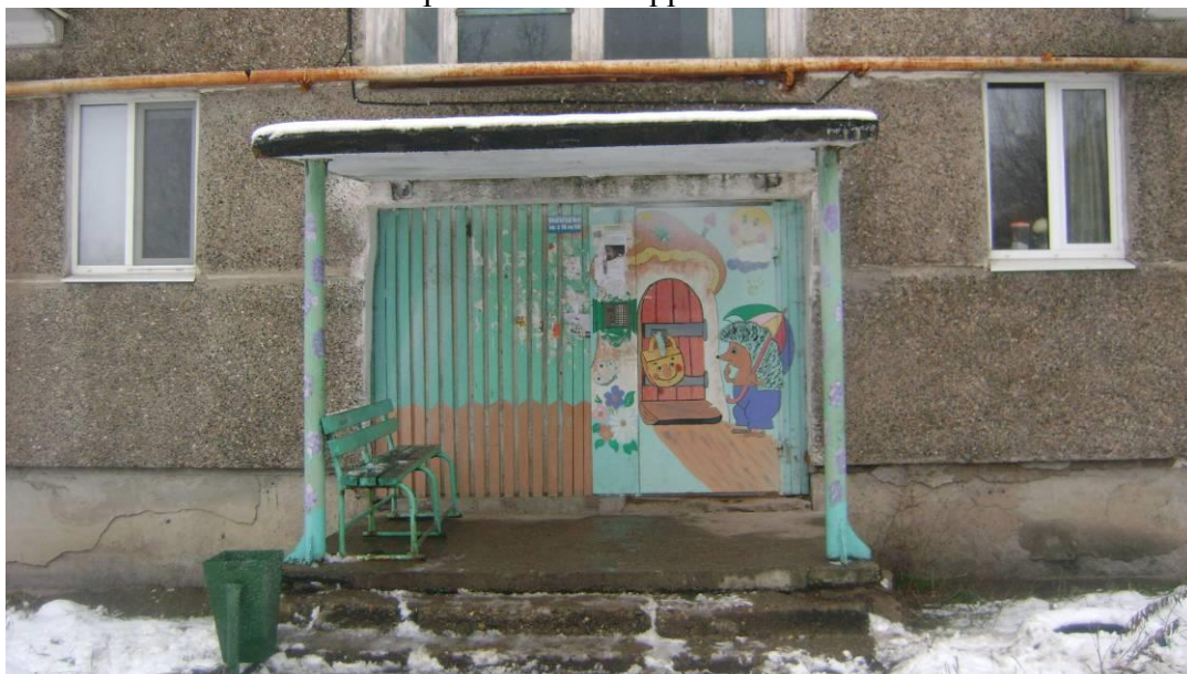
Фото 11. Выбоины в бетоне ступеней крыльца. Следы увлажнения козырька, поражение биокоррозией.
