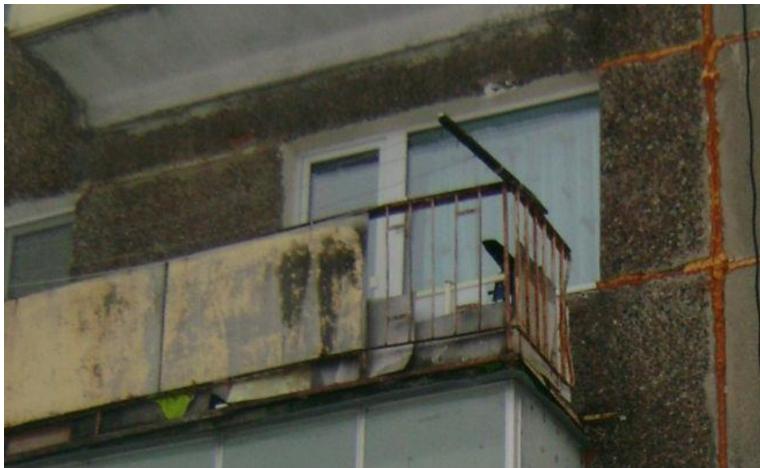
Фото 20. Балконы. Поражение коррозией металлических несущих конструкций. Следы увлажнения на нижней плоскости плиты.
