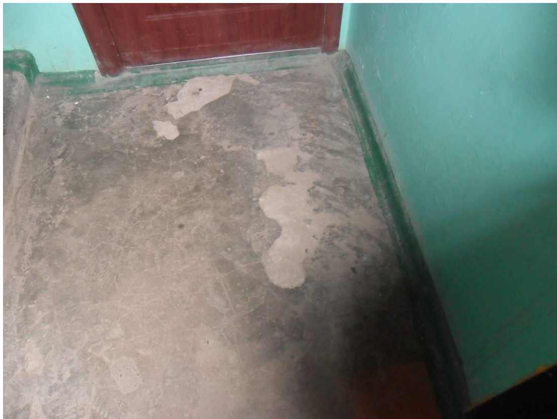
Фото 16. Подъезд. Выбоины бетонного пола.
