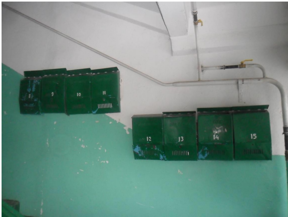
Фото 14. Подъезд. Отслоение окрасочного слоя внутренних стен и перегородок местами.
