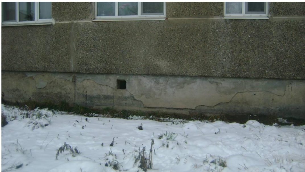
Фото 4. Следы увлажнения стен и цоколя. Отпадение штукатурного слоя цоколя.
