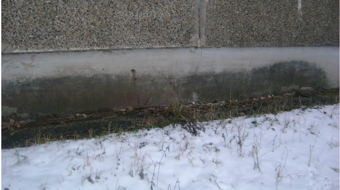
Фото 7. Следы увлажнения цоколя. Цоколь поражен биокоррозией. Разрушение отмостки.
