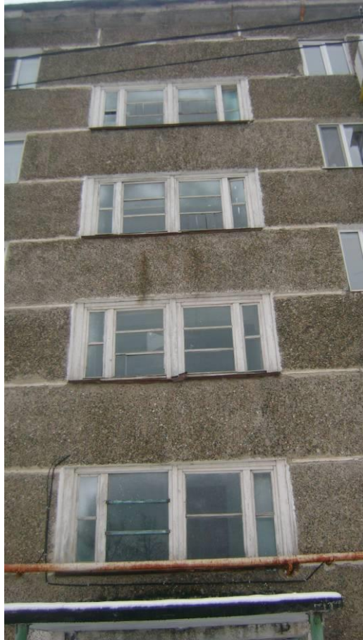
Фото 22. Рассыхание и коробление оконных блоков.
