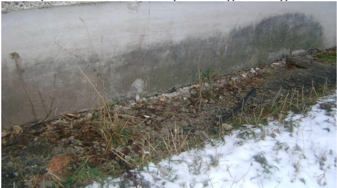
Фото 8. Следы увлажнения цоколя. Цоколь поражен биокоррозией. Разрушение отмостки.
