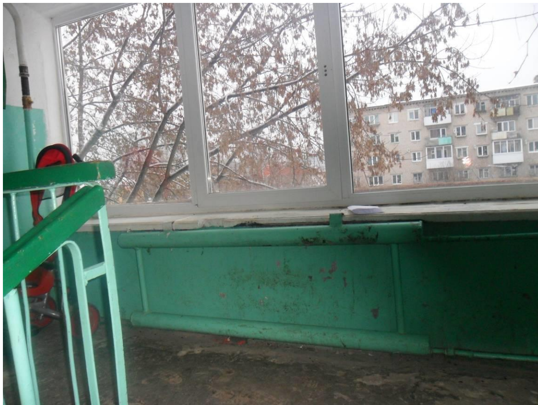
Фото 18. Подъезд. Нарушение окраски отопительных приборов.
