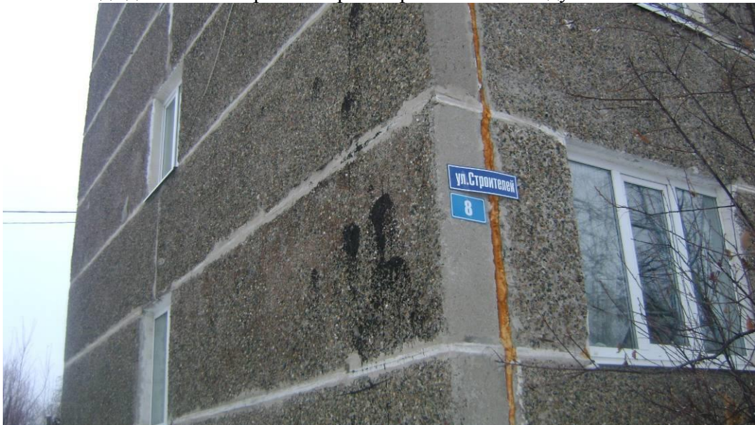
Фото 2. Фрагмент торцевого фасада. Выветривание раствора из швов между стеновыми панелями. Следы увлажнения стен.
