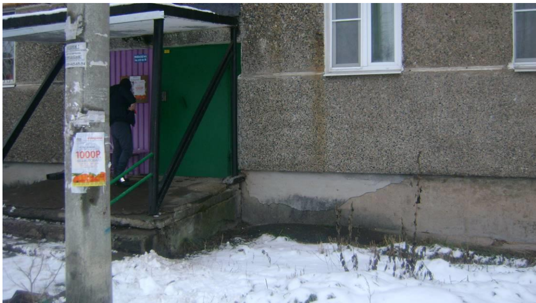
Фото 10. Следы увлажнения цоколя. Поражение биокоррозией. Разрушение бетона крыльца, поражение биокоррозией.
