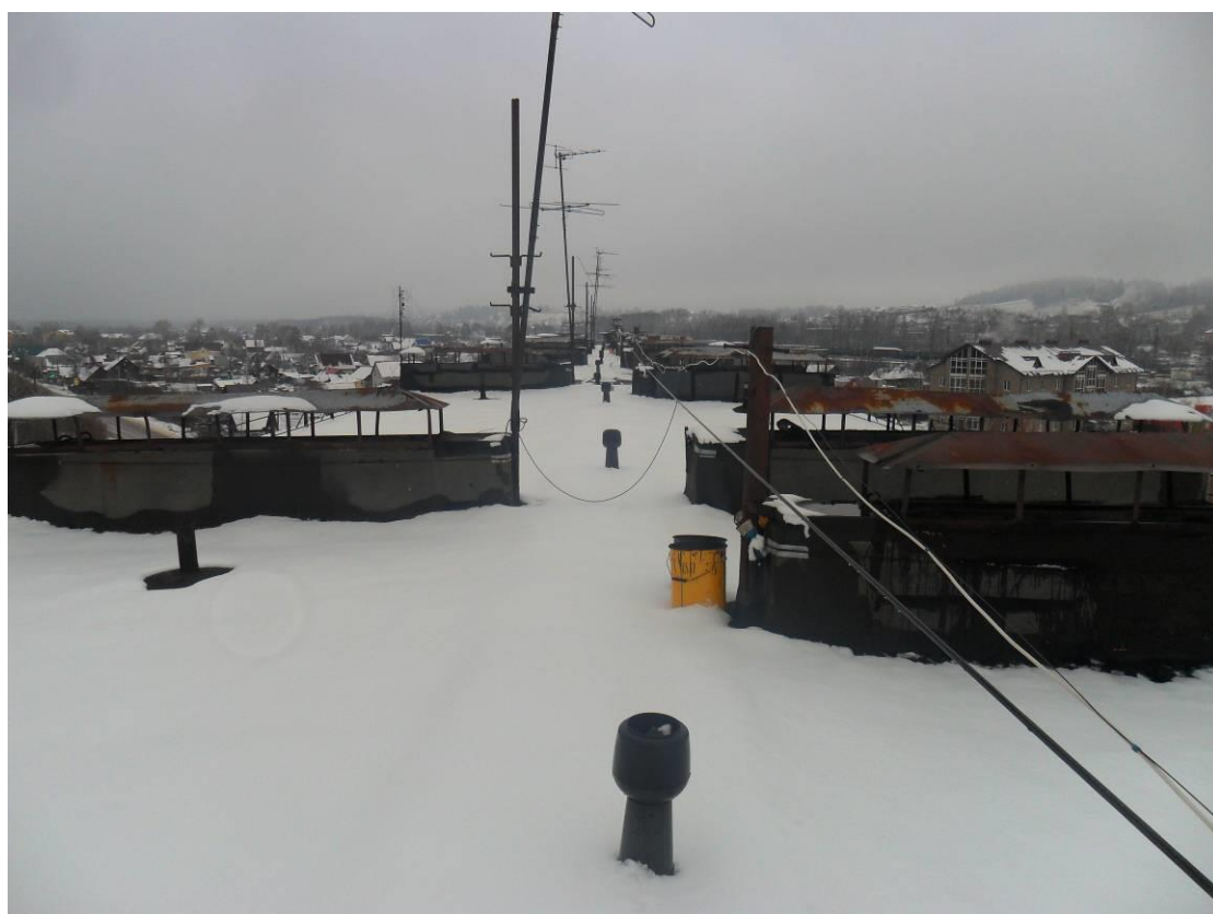
Фото 21. Поражение коррозией вентиляционных шахт.
