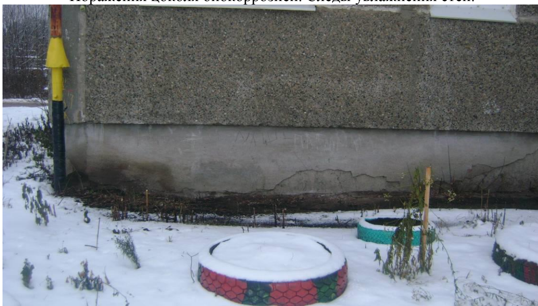
Фото 6. Отпадение штукатурного слоя цоколя. Поражение биокоррозией.
