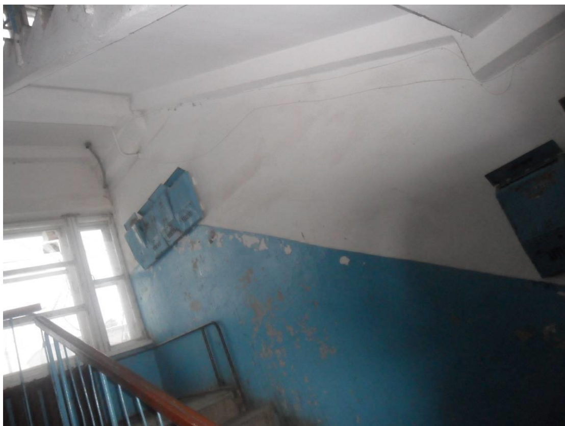
Фото 13. Подъезд. Загрязнение окрасочного слоя внутренних стен и перегородок, отслоение.
