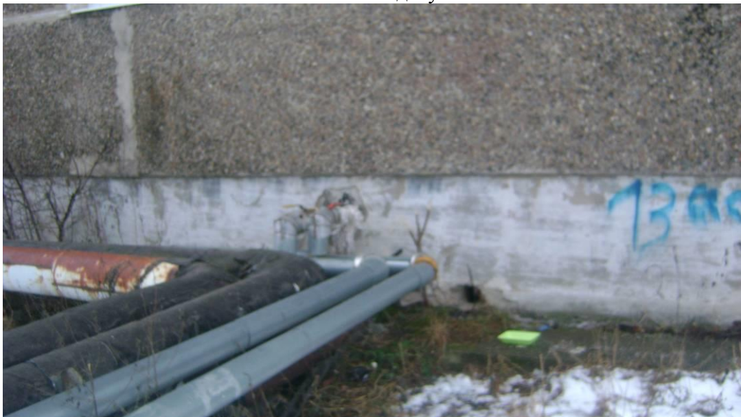
Фото 3. Следы увлажнения цоколя и стен.
