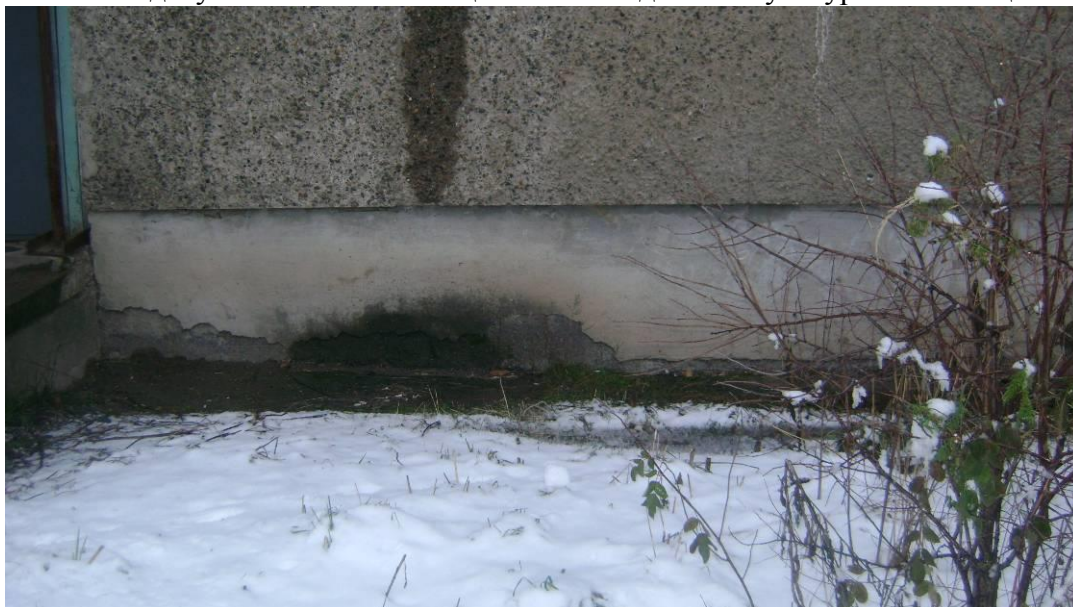
Фото 5. Следы увлажнения цоколя. Отпадение штукатурного слоя цоколя. Поражения цоколя биокоррозией. Следы увлажнения стен.
