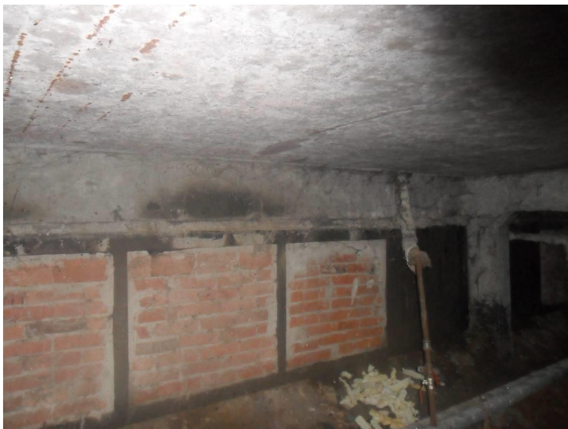
Фото 19. Подвал. Следы увлажнения стен и перекрытий.
