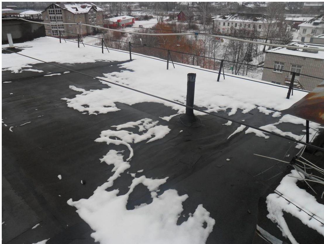
Фото 12. Вздутие поверхностей кровли, трещины.
